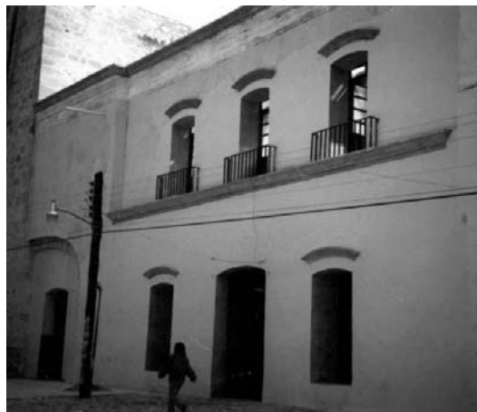
Figura 2. Al inicio de los trabajos de clasificación, la falta de un techo en la planta superior del ex convento provocó la inundación del archivo. Nuevamente se perdía parte del valioso acervo de los mixtecos.
