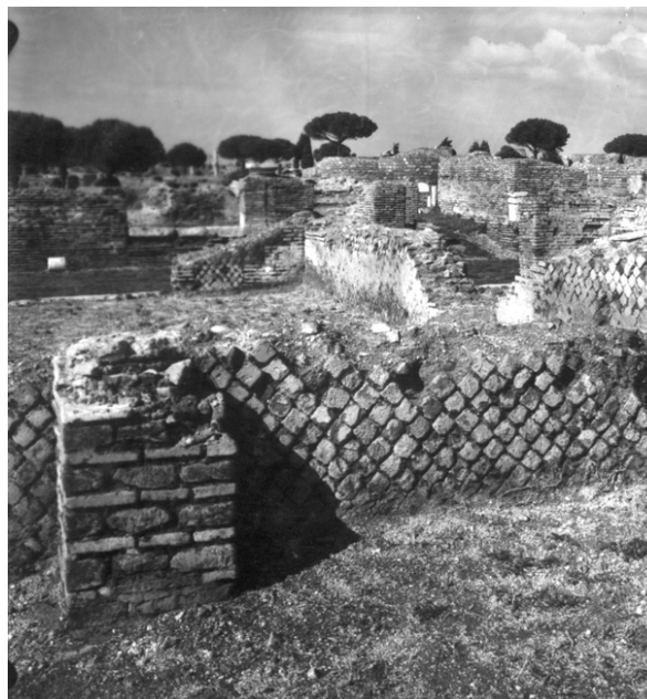
Fig. 5.79 – Building (IV ii 8), reinforcing pillars in room (7), (Scavi di Ostia, Archivio Fotografico, ref. 1769)
