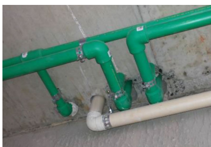
Figura 5 – Exemplo de quebra de compartimentação vertical em laje por tubulação hidráulica.
