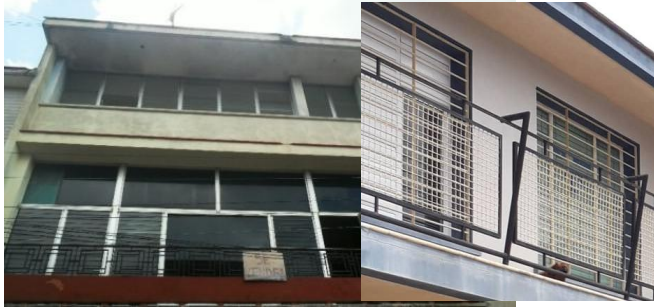
Fig. 3 Cambios operados en los vanos para un mejor logro de la relación interior-externo. Edificio en Popular No. 126 (1958) y vivienda en Avenida de los Mártires No.359 (1958)
