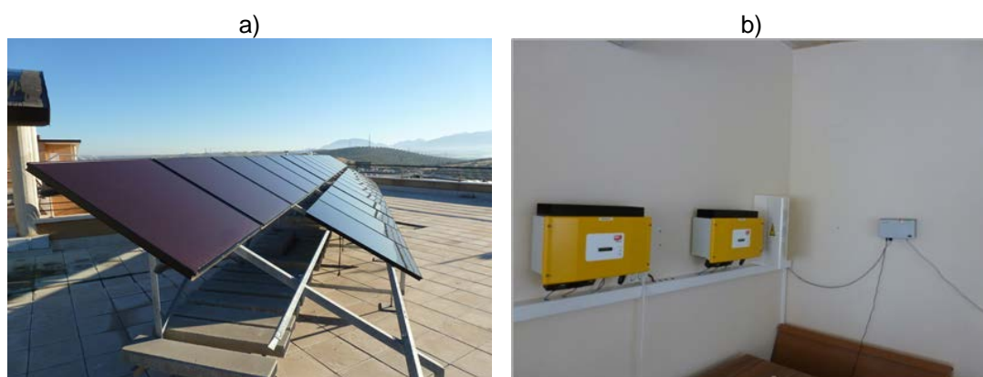
Figura 10. SFCR con GFV de LD instalados en la terraza de la Universidad de Jaén: a) GFV de a-Si (fila superior de módulos) y a-Si/ \mu c-Si (fila inferior de módulos) y b) Inversores a los que se hallan conectados sendos GFV, junto a caja de protecciones AC y medidores de energía inyectada a la red. A la derecha se aprecia el registrador automático de datos conectado a Internet.
