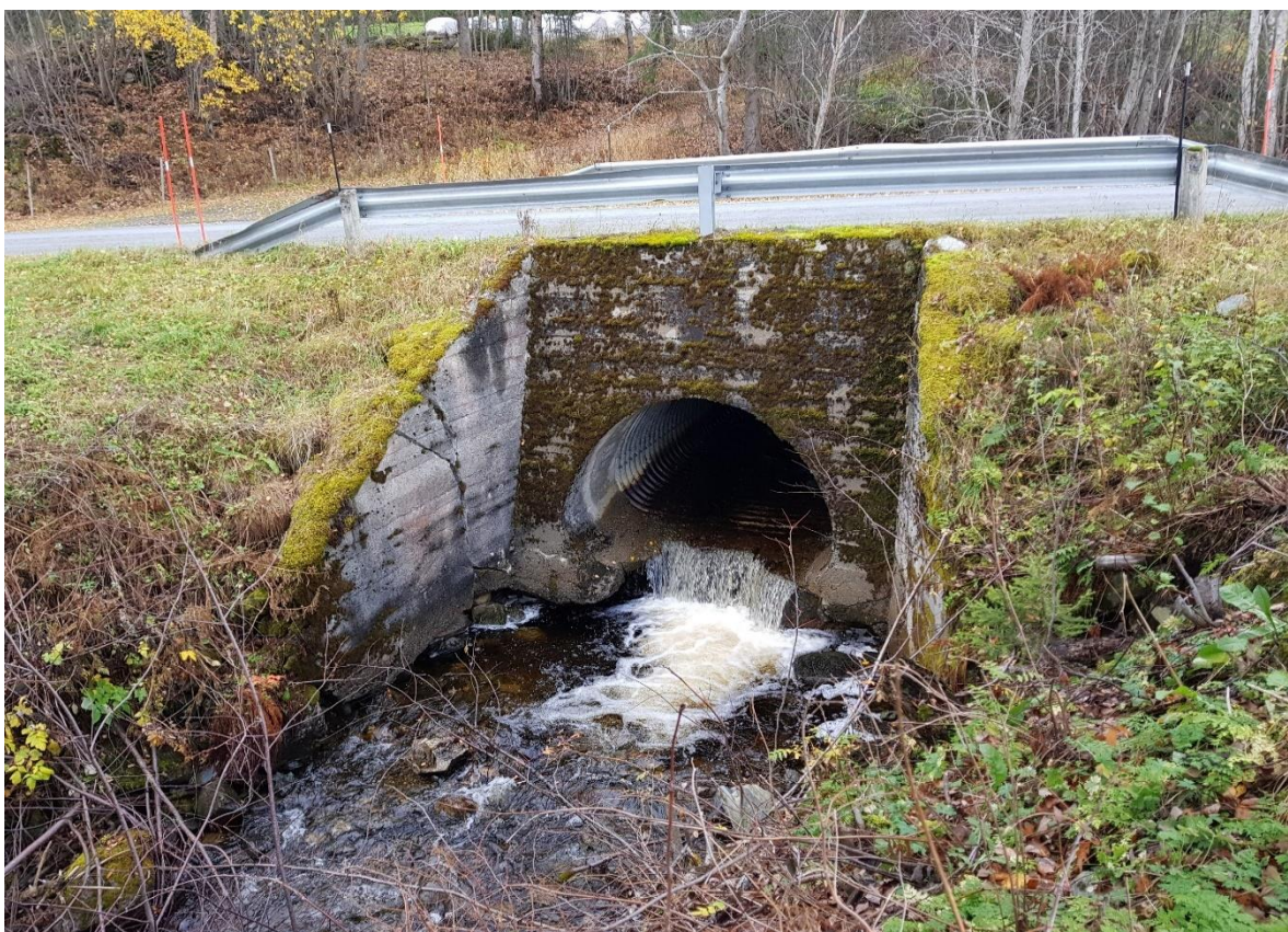
Bilde 153. Kulvert under Tverdalsveien er i dag et vandringshinder for anadrom laksefisk i Verja. Foto: Øyvind Solem, NINA.
