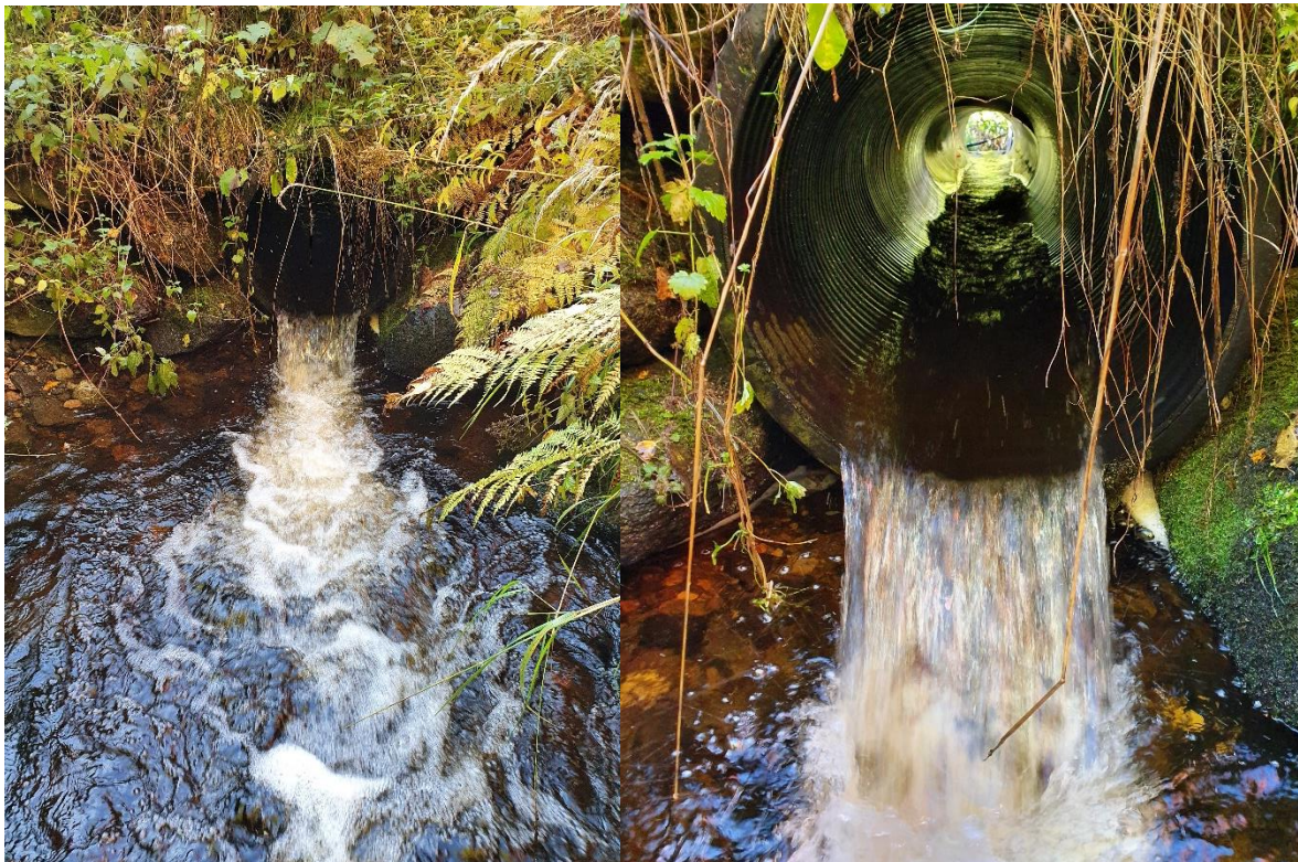
Bilde 189. Et sideløp til bekken går i kulvert under gårdsvei ved Nedre Myran. Kulverten er en potensiell vandringsbarriere. Foto: Torgeir B. Havn, NINA.
