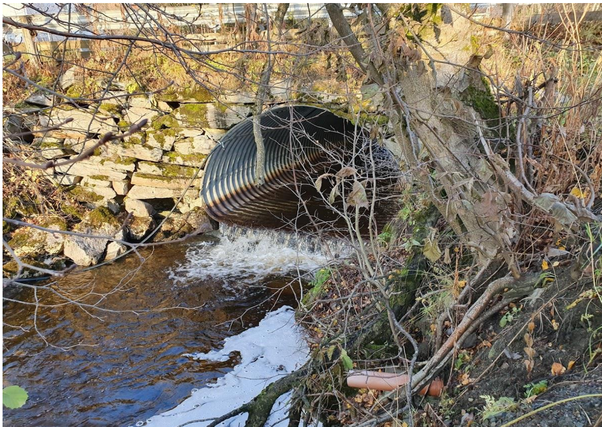
Bilde 94. Kulvert under Ressveien er på grunn av sin utforming et vandringshinder for ungfisk av laks og ørret, samt trolig også i perioder for gytefisk av laks og sjørørret. Foto: Øyvind Solem, NINA.
