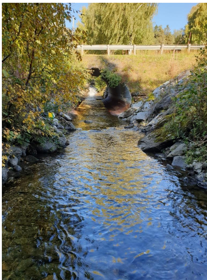
Bilde 168. Røra er lagt i kulvert under Orkdalsveien om lag 300 meter ovenfor samløpet med Orkla. Oppstrøms kulverten skimtes betongplata som fungerer som vandringsbarriere for fisk. Foto: Espen Holthe, NINA.
