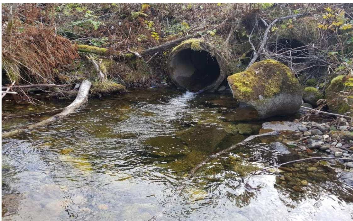
Bilde 201. Kulverten under skogsbilveien ved Skugglia. Kulverten er uhensiktsmessig utformet med tanke på å sikre tilfredsstillende oppvandring av laks og ørret. Foto: Øyvind Solem, NINA.
