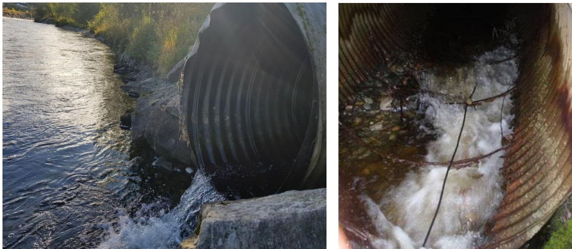
Bilde 52. Venstre: Selv når Orkla går med vannføring over middels som her på undersøkelsestidspunktet i 2017 er det litt for stort sprang opp til kulvert i utløp av Tonga. Høyre: Kulvert gjennom forbygning der med Tunga munner ut i Orkla i 2010. Jernstenger gjorde det da tilnærmet umulig for fisk å vandre opp i vassdraget. Foto: Øyvind Solem (venstre) og Morten Andre Bergan (høyre), NINA.
