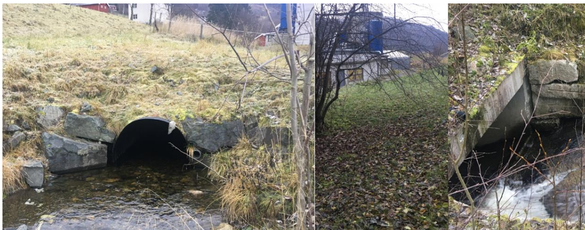
Bilde 92. Utløp (t.v.), lukket parti ved Lium Møbelverksted (midten) ved og innløp (t.h.) til kulvert i Vigda. Foto: Morten André Bergan, NINA.
