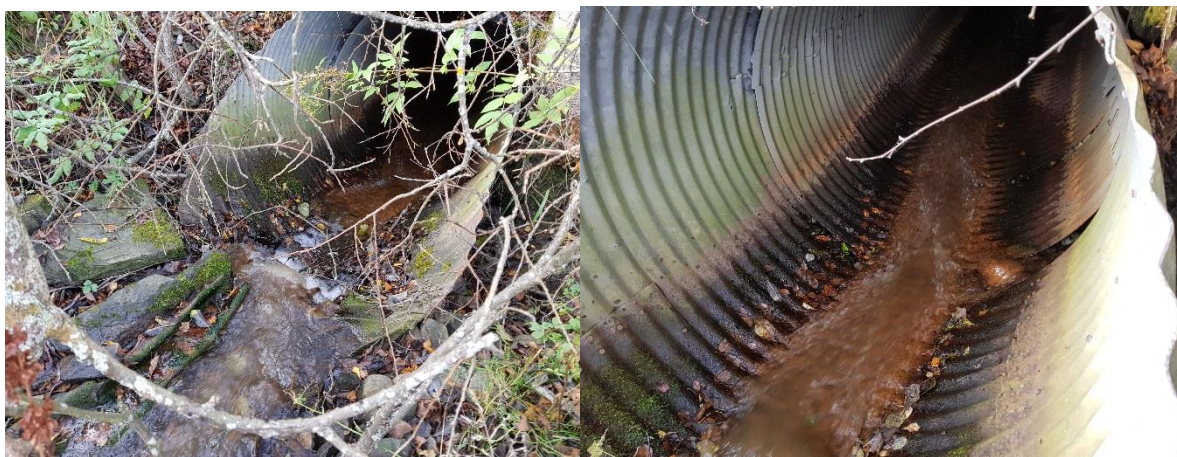
Bilde 13. Kulvert i Mobekken under Blåsmovegen. Trolig er passering av denne problematisk både på høy og lav vannføring. Foto: Øyvind Solem, NINA.
