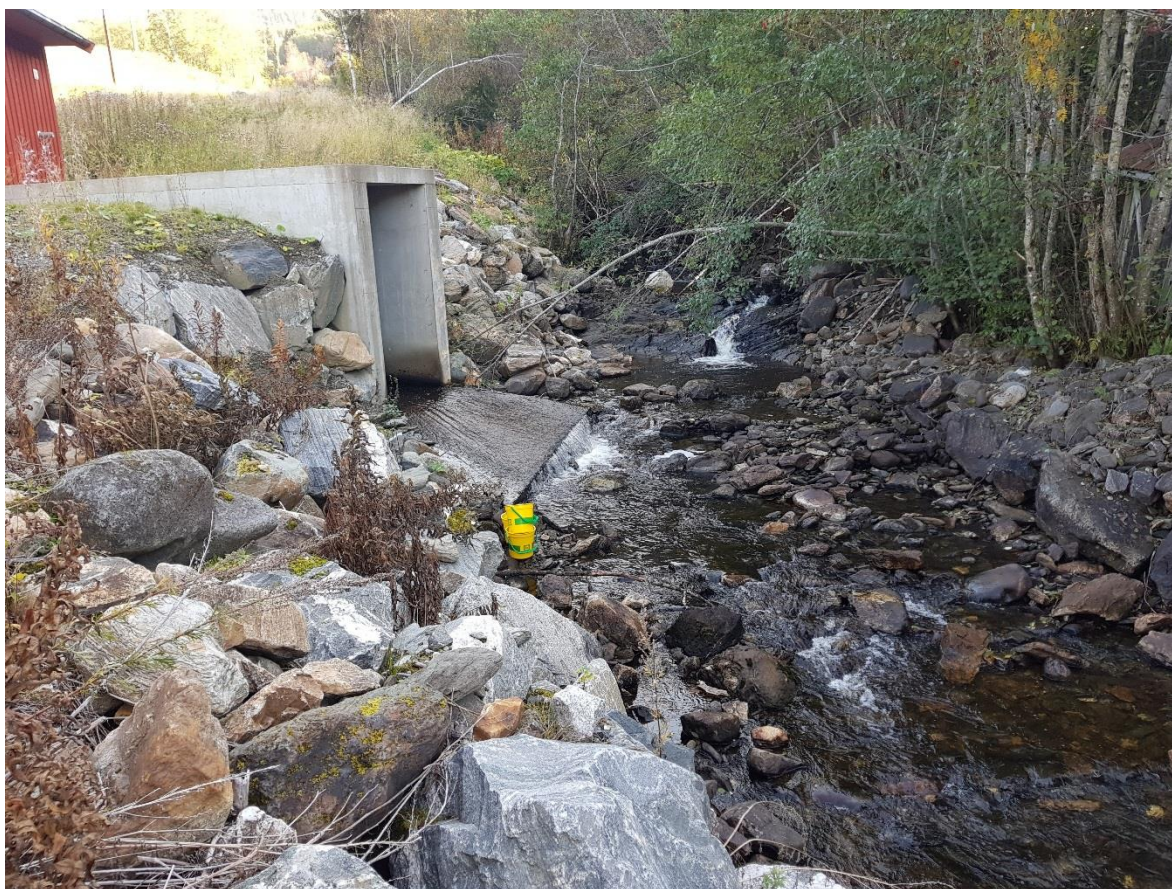
Bilde 11. Øvre del av stasjon i Follobekken med utløp av Sundli kraftverk. Vandringsbarriere for anadrom laksefisk ses litt opp for midten av bilde. Foto: Øyvind Solem, NINA.
