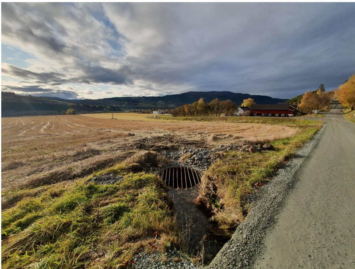
Bilde 111. Kulvert under Grutaveien og kum fra der Vinna lagt i rør under dyrkamarka. Foto: Øyvind Solem, NINA.
