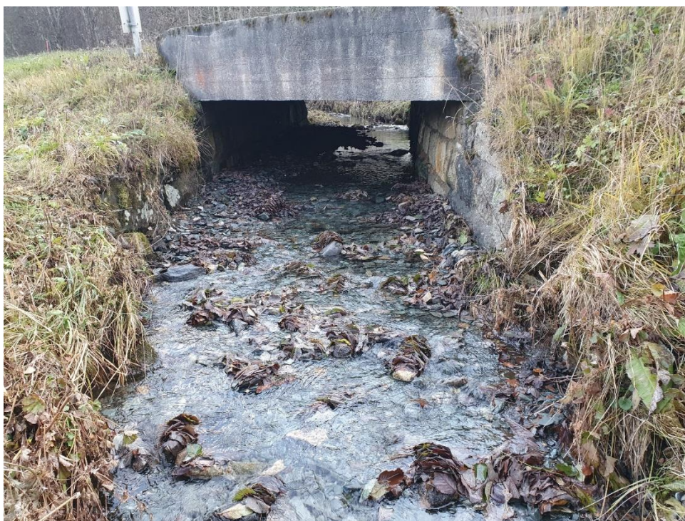
Bilde 142. Kulvert under Fv. 700 er bygd opp som en bru med naturlig elvegrus i bunnen. Foto: Øyvind Solem, NINA.
