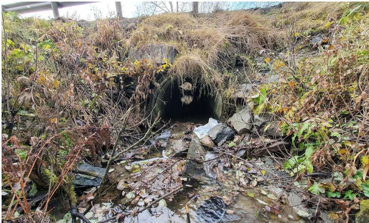
Bilde 45. Kulvert under Fv. 65 fremsto høsten 2019 som et vandringshinder på noen vannføringer, da det i nedre del var lagt opp en del stein i munningen. Innløp var delvis blokkert og skimtes så vidt gjennom røret. Foto: Øyvind Solem; NINA.
