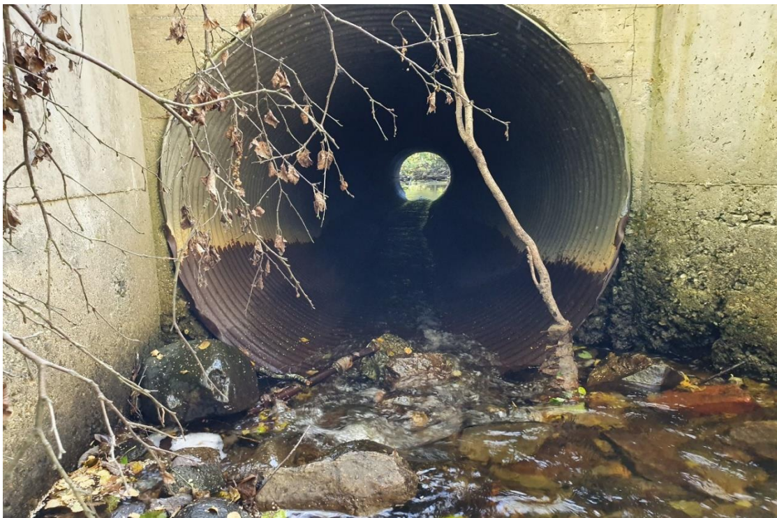
Bilde 158. Kulverten under Fv. 700 var høsten 2019 fri for kvist, men vurderes til å være et vandringshinder for anadrom laksefisk på visse vannføringer. Foto: Øyvind Solem, NINA.
