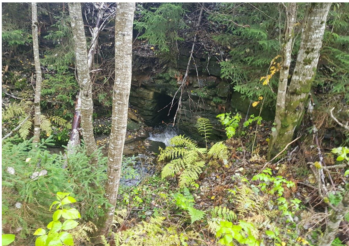
Bilde 21. Øvre del av kulvert under jernbane ble under befaring høsten 2018 vurdert til å kunne være periodevis vandringshindrende. Oppgangsforholdene er verre enn naturlig, og problems-tillingen må følges opp. Foto: Øyvind Solem, NINA.
