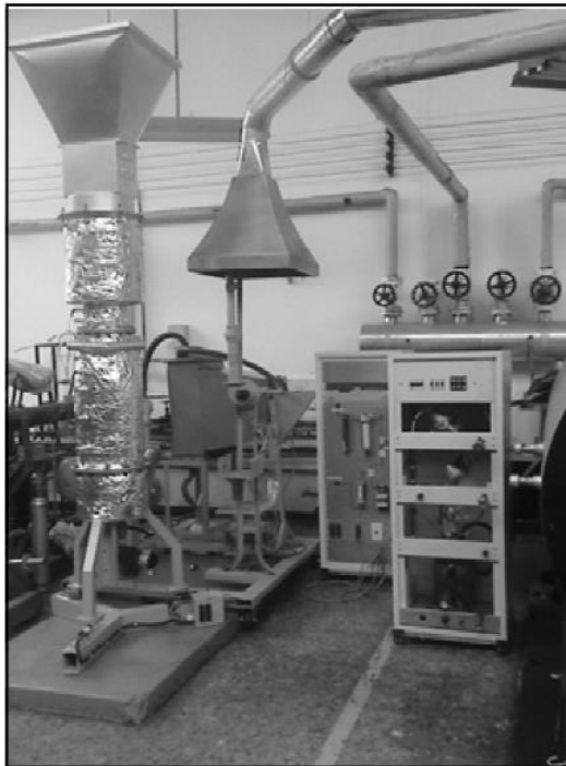
Figura 10. Equipo de gasificación.
