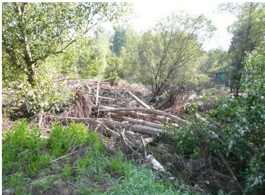
Рисунок 2. Карчи, скопившиеся перед мостовым отверстием дороги Яжелбицы-Дворец. Фото А.Ю. Виноградова Figure 2. Submerged tree stump, accumulated in front of the bridge opening of the road Yazhelbitsy-Dvorec. Photo by Alexey Yu. Vinogradov
