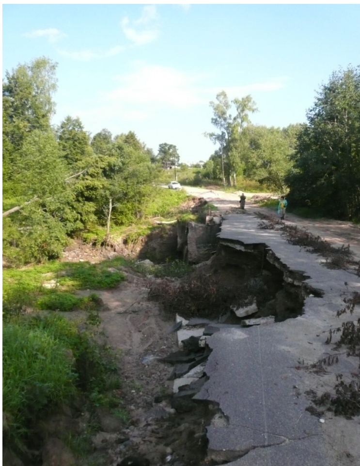
Рисунок 3. Размыв автодороги и частичное разрушение мостового перехода. Фото А.Ю. Виноградова Figure 3. Road erosion and partial destruction of the bridge crossing. Photo by Alexey Yu. Vinogradov
