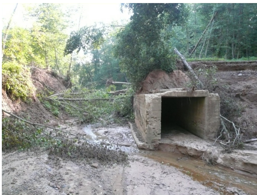
Рисунок 4. Водопропускное отверстие автодороги было полностью забито карчами, что привело к разрушению дорожного полотна. Фото А.Ю. Виноградова Figure 4. The culvert of the road was completely clogged by submerged tree stumps, which led to the destruction of the roadway. Photo by Alexey Yu. Vinogradov
