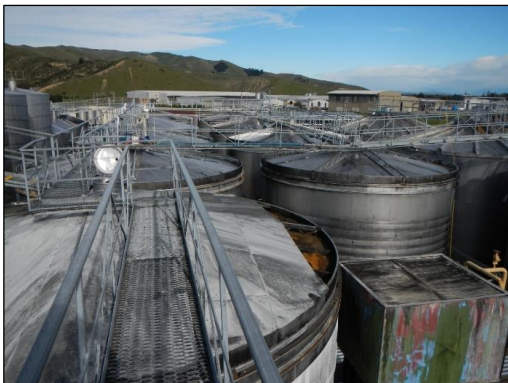
(a) Tank 400 kL
