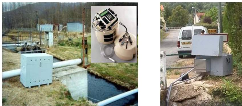
Figure II - 14 : Exemples d'installation - à gauche, installation d'un préleveur sur le canal de dérivation de la Nive des Aldudes (pisciculture Ispéguy) ; à droite, installation sur un des affluents du Riou Mort (Firmi).
