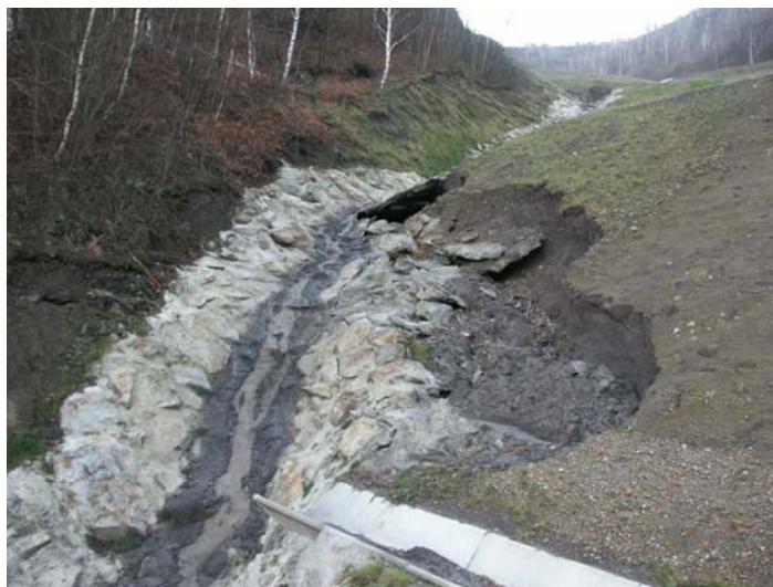
Figure V - 81 : Erosion du bassin du PTN.
