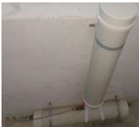
Figura 3. Sistema de aquecimento do piso térmico com dois reservatórios de água. No reservatório superior há um aquecedor. No reservatório inferior, uma bomba d'água que envia a água que circula o piso novamente para o reservatório superior.
