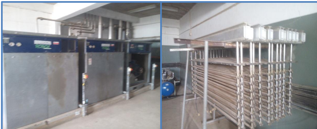
Figura 5.17 – Edifício dos compressores (onde também são guardadas os módulos de lâmpadas UV)
