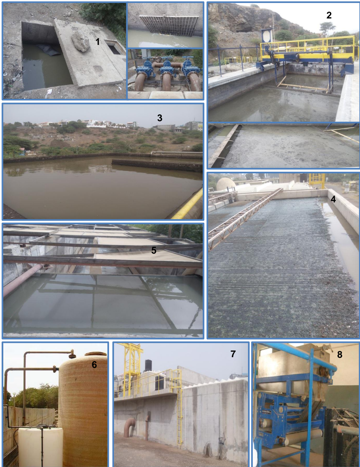
Figura 5.15 – Órgãos utilizados em operações e processos de tratamento de águas residuais na ETAR do Palmarejo (1 – Tanque de recepção com grade e poço de bombagem do efluente gradado; 2 – Decantadores primários; 3 – Reactor biológico; 4 – Decantador secundário (com lamelas); 5 – canal de cloragem da água clarificada; 6 – sistema de dosagem do cloro; 7 – edifício de espessamento das lamas; 8 – Edifício de desidratação das lamas (filtro prensa).
