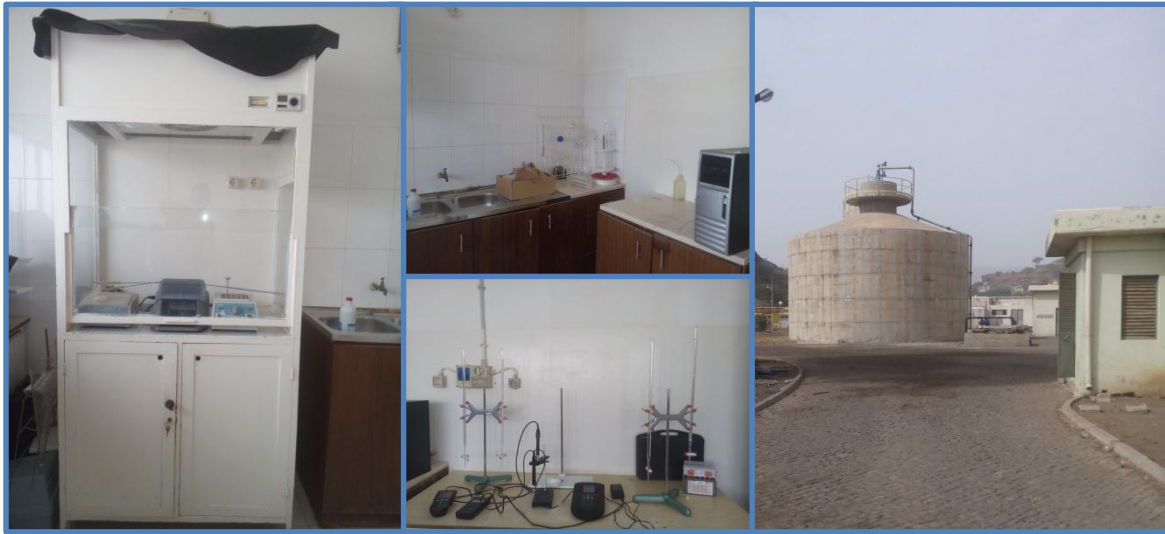
Figura 5.16 – Digestor de lamas (inoperacional) e laboratório.
