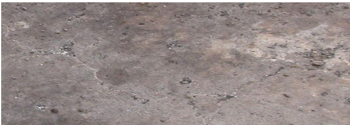
Figura 29 - Laje exposta sem impermeabilização [fonte: o autor]
