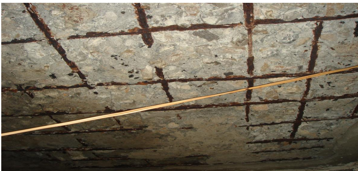
Figura 7 - Corrosão uniforme [fonte: autor]
