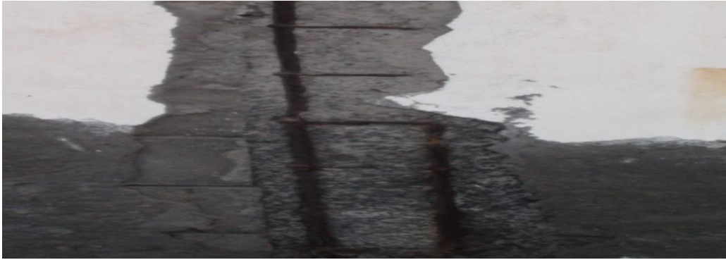
Figura 38 - Imagem de um pilar oxidado [fonte: o autor]
