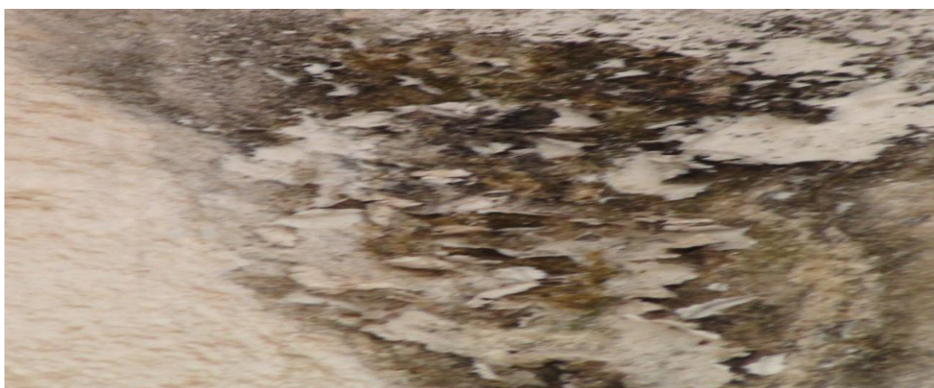
Figura 34 – Parede com manchas [fonte: o autor]
