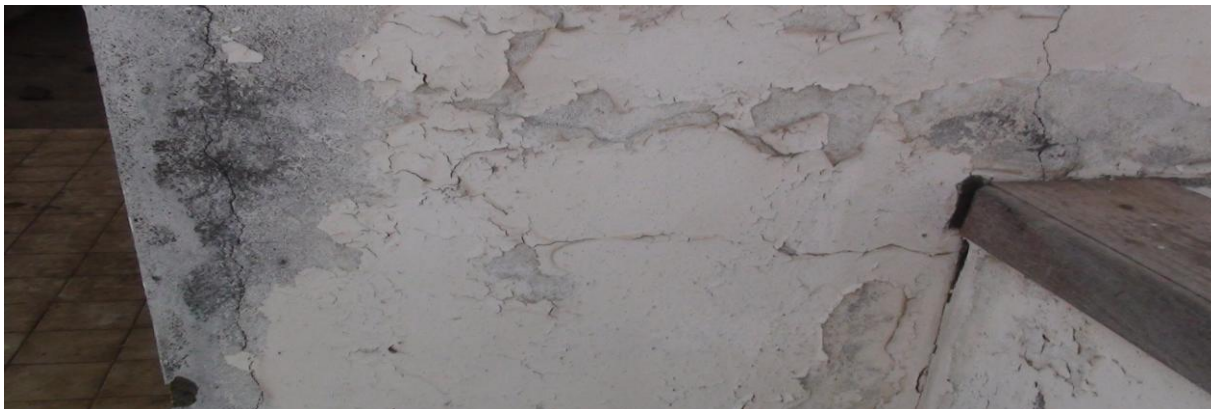
Figura 33 - Parede com marcas de descascamento [fonte: o autor]
