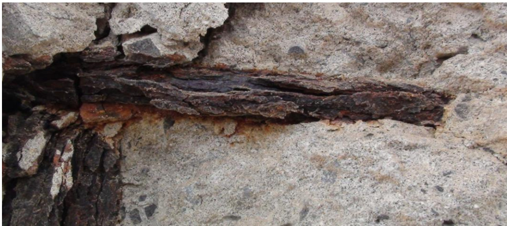
Figura 39 - Imagem de armadura de uma viga oxidada [fonte: o autor]
