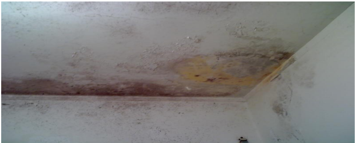
Figura 11 - Humidade de uma laje.[fonte: Autor]
