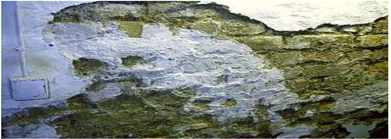
Figura 10 - Eflorescência [fonte: Marçal et al., 2008]
