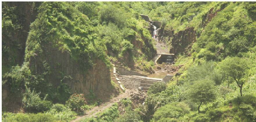
Figura 5 – Diques (argamassados) de correcção torrencial e captação de água (sub-bacia de Mato Gégé) com escadas de acesso para permitir a mobilidade pela ribeira.
