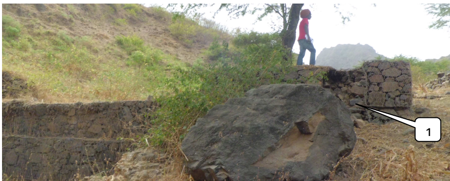
Figura 7 - Dique de gabião, onde foi tirada uma quadra de gabião (1) de uma das asas.
