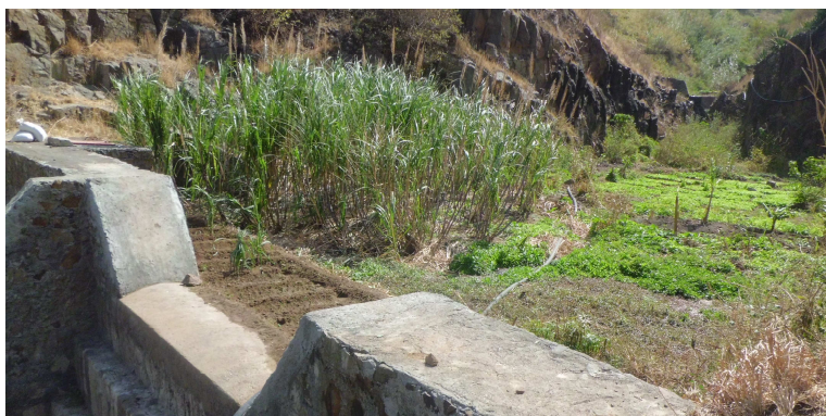
Figura 6 – Dique argamassado de captação de água totalmente assoreado e aproveitado para fazer agricultura irrigada.
