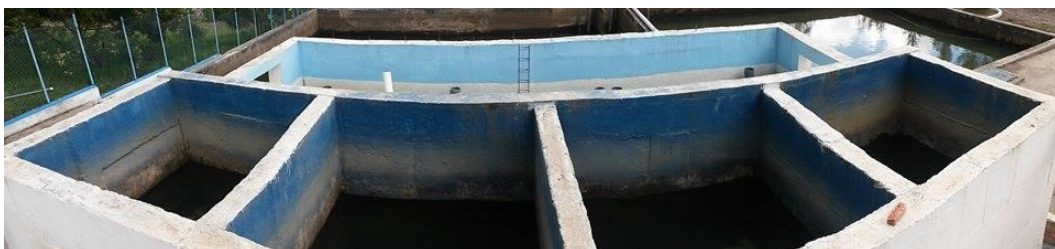
Figura 2-7 Batería de 4 filtros
