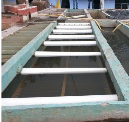
Figura 2-6 Decantadores de Flujo Ascendente
