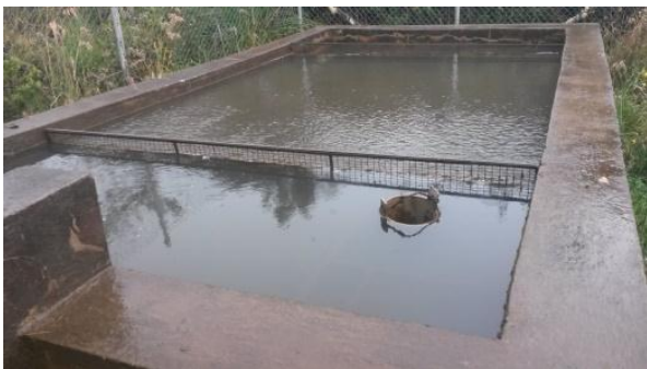
Figura. 1-3. Captación Santa Ana
