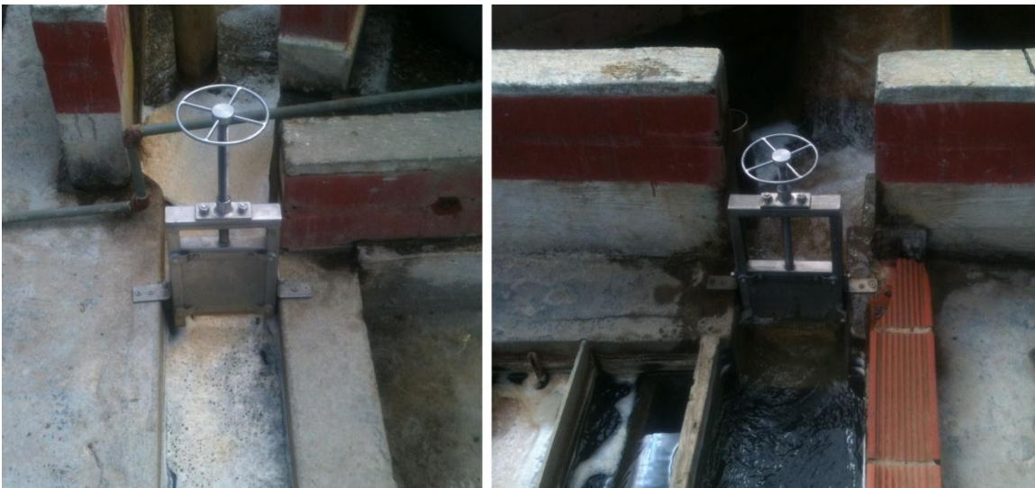
15E: Compuertas en funcionamiento
