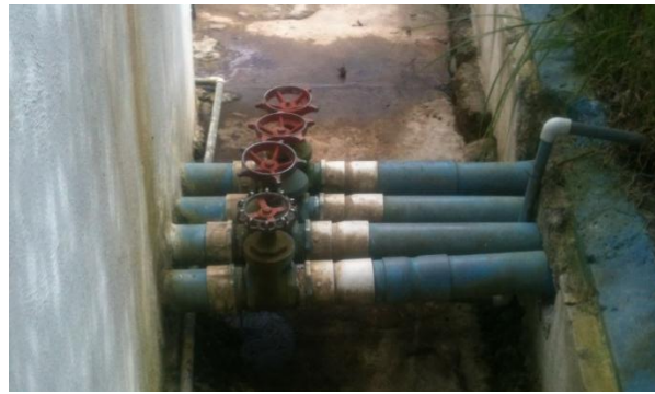
15G: Equipo dosificador instalado y en funcionamiento
