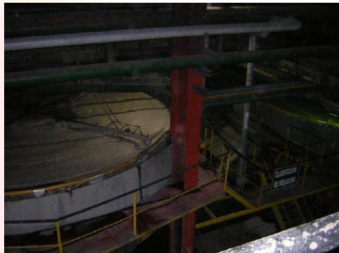
Fig. 14 Tanque de Clarificador de Meladura Fuente: INGENIO LA TRONCAL, 2011
