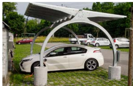
Der Solarcarport der BFH-TI in Burgdorf
