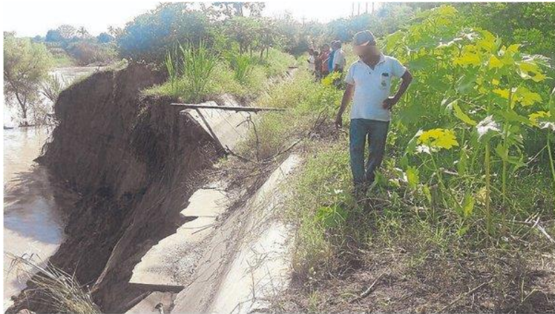
Figura N° 5. Colapso de un Canal de regadío (Fuente: Diario el Correo - 2018) BOLIVIA.
