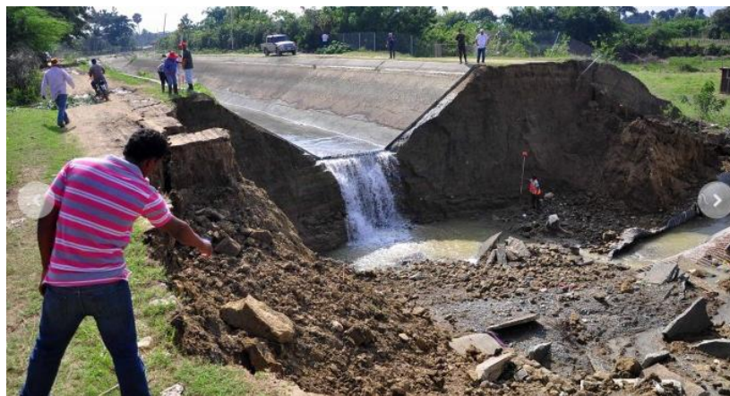
Figura N° 3 Colapso del canal Ulises Francisco Espaillat (Fuente: Diario Libre – 2016) REPÚBLICA DOMINICANA
