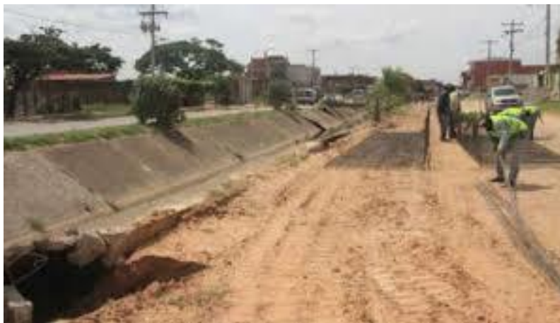
Figura N° 1 Socavación en canal Bolivia (Fuente: Hoy Bolivia.com - 2015) BOLIVIA.
