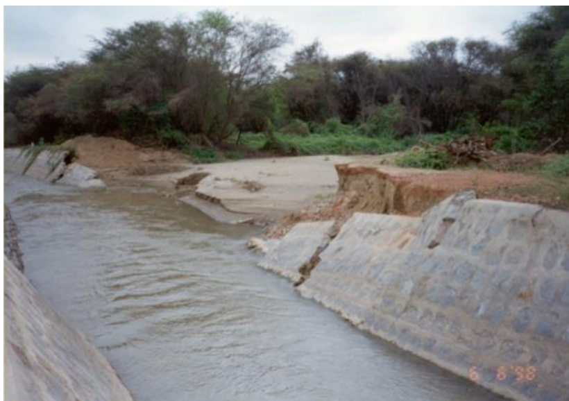
Figura N° 8. Fallas en Canal Taymi (Andina - 2015) LAMBAYEQUE
