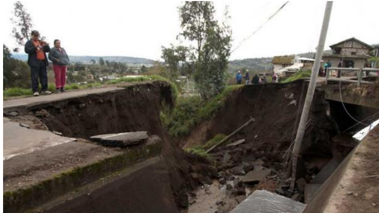
Figura N° 2 Colapso del canal Abanto – Huachi – Pelileo (Fuente: El comercio – 2016) ECUADOR
