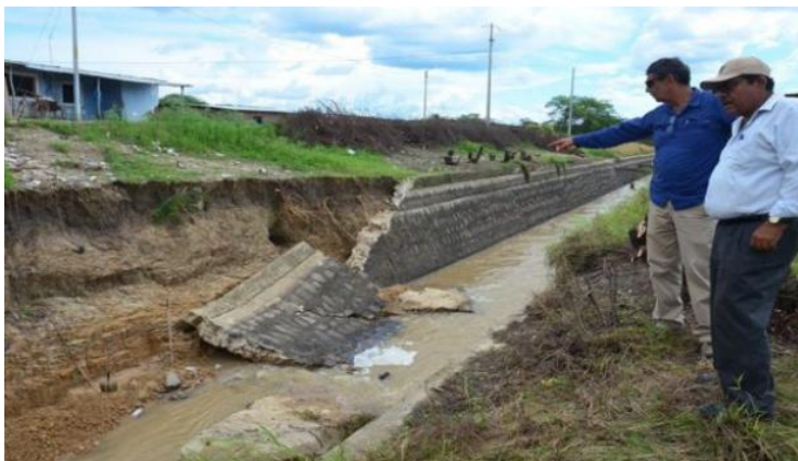
Figura N° 6. Fallas en Canal de regadío (Fuente: Andina - 2017) AREQUIPA.
