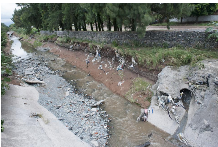
Figura N° 4 Colapso del canal Norte (Fuente: Diario La Gaceta – 2016) ARGENTINA
