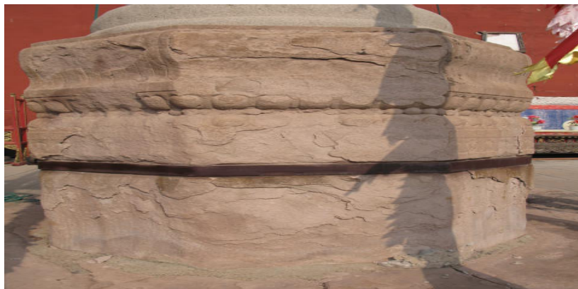
图12大红台前石柱：剥落，裂
