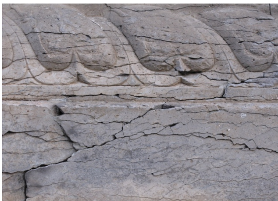
图20 碑亭底座：表面线状开裂
