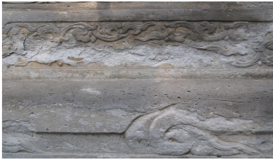
图10碑亭台基：盐性腐蚀及剥离
