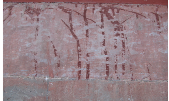
图14碑亭墙：油漆破坏产生污迹，变色
