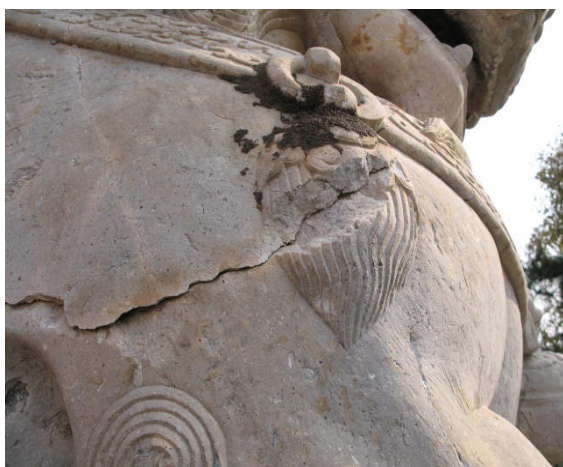
图17石狮头部下面：鸟粪，缺失裂缝
