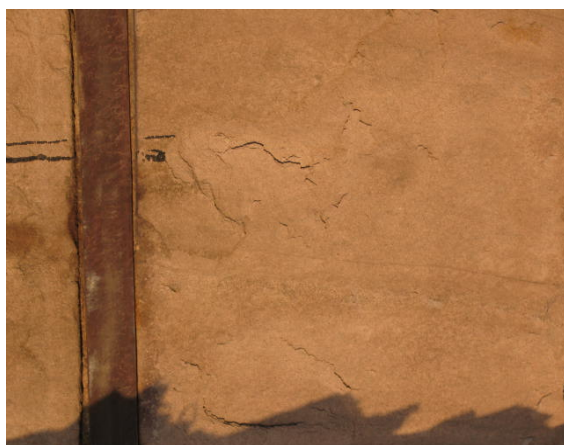
图22大红台前石柱：铁质材料加固引起污迹
