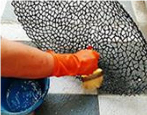
4.2.a) Pembersihan hasil las yang gosong dengan gel pembersih stainless steel (dokumen pribadi, 2020).
