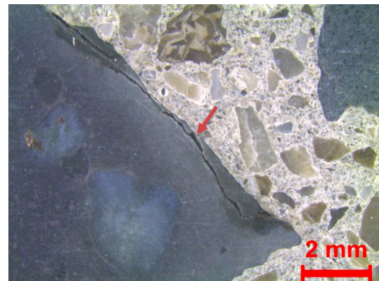
(d) Edge crack without gel.
