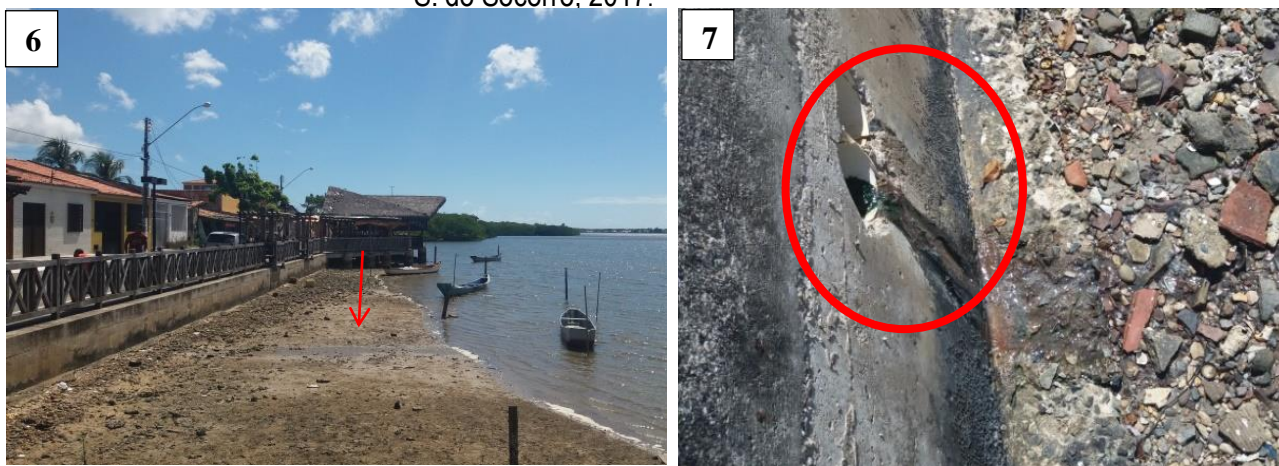
Figuras 06 e 07: Registros de derramamento de esgoto próximo à margem do rio do Sal Pov. São /N. S. do Socorro, 2017.
