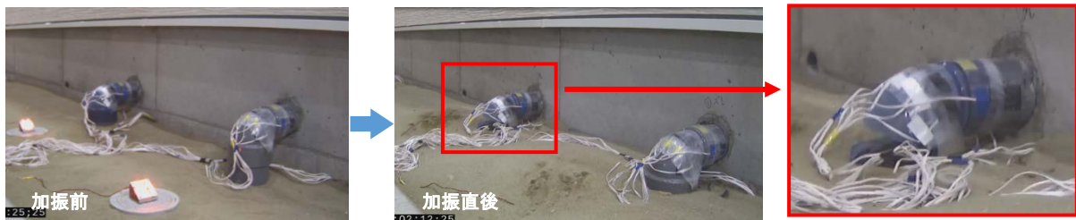
(2) B 棟における、べた基礎の移動による排水管の破断状況
