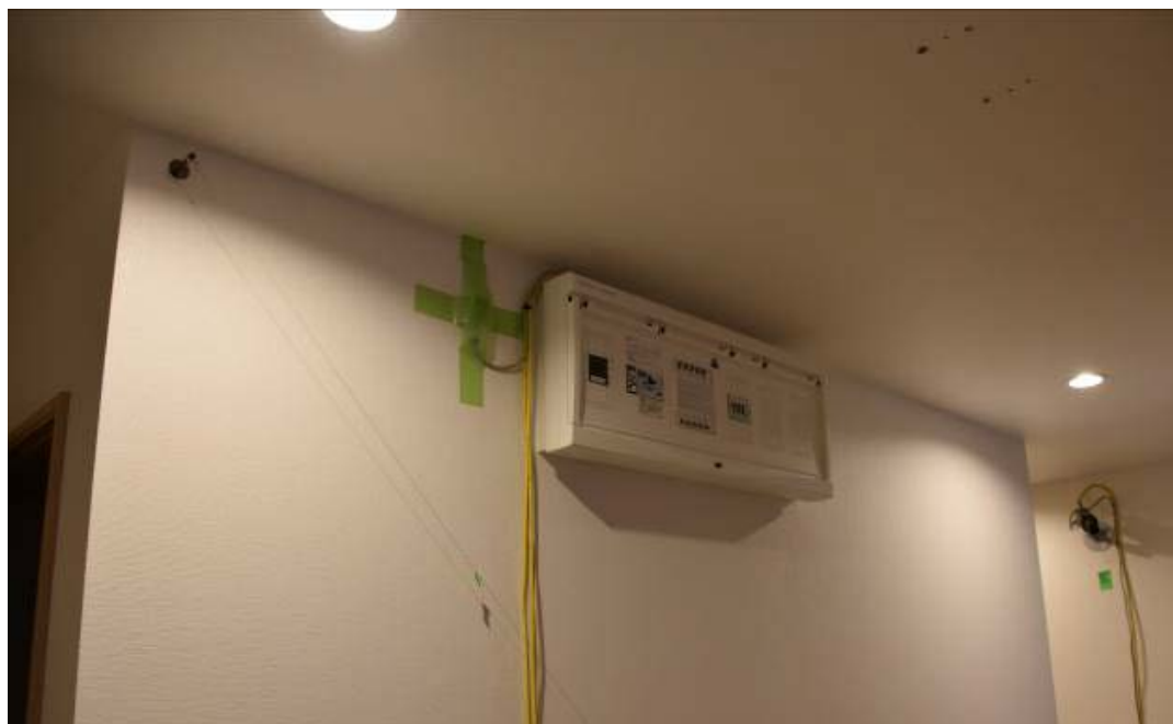
図 3 感震ブレーカーの設置状況
