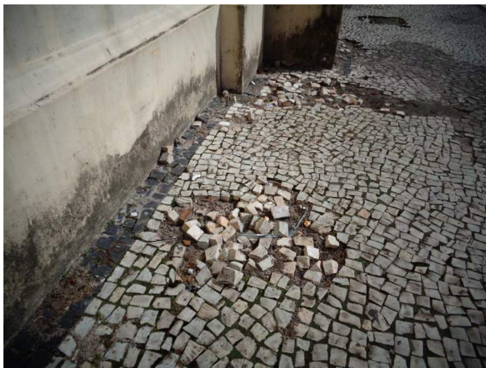
Figura 5. Passagem de pedestre com danos no calçamento Autor: Arquivo pessoal, 2016
