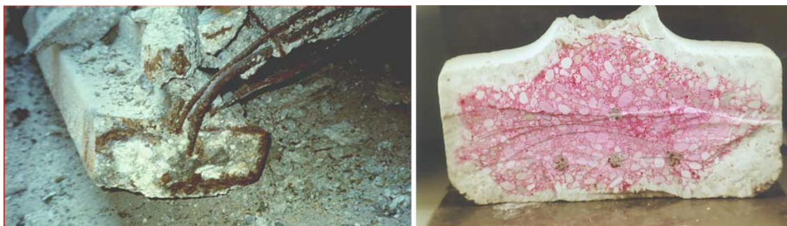
Slika 2. 1 Oštećenja prednapregnute krovene konstrukcije industrijske hale u Veroni usled korozije izazvane karbonatizacijom, Italija (1980-1997)
