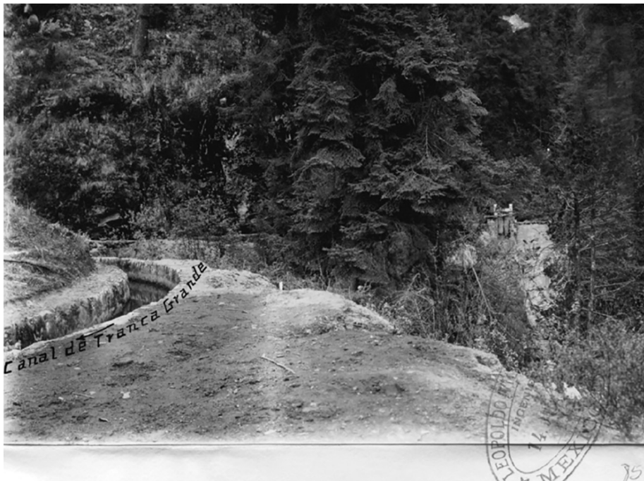
IMAGEN 1. CANAL DE TRANCA GRANDE QUE TRANSPORTABA LAS AGUAS A LA PRESA LA CUESTA.
