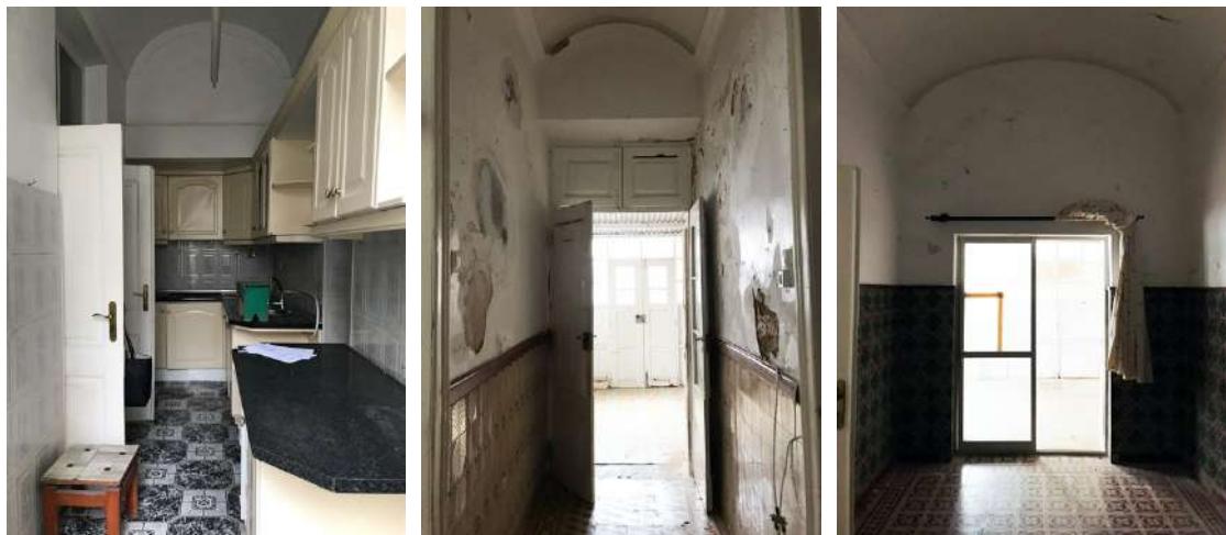
Figura 176 – Fotografia da cozinha. Figura 177 – Fotografia do extremo do corredor, antes do pátio coberto. Figura 178 – Fotografia do terceiro quarto, onde é possível observar o material descaracterizado da porta-janela.
