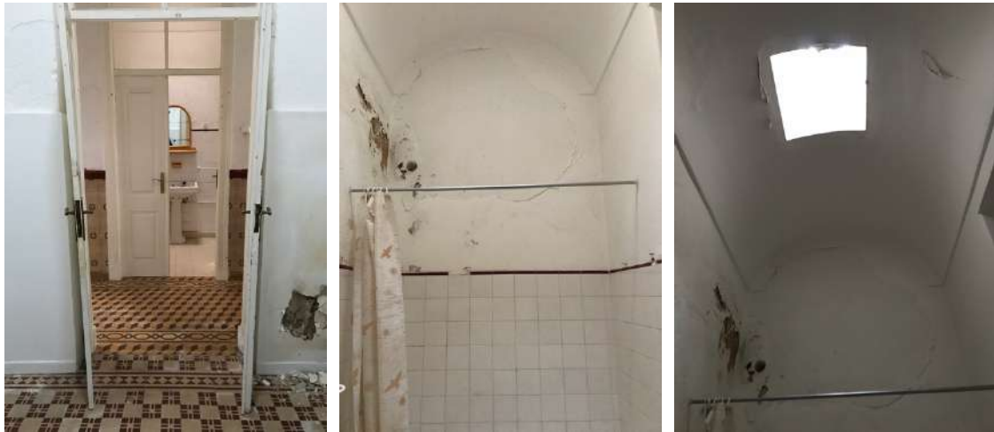
Figura 174 – Fotografia parcial do quarto dois, onde é possível verificar a existência de humidades ascendentes nas paredes junto à porta. Figura 175 – Fotografias da instalação sanitária, verificando humidades nas paredes e no teto. É possível observar o estado da pintura a cair.
