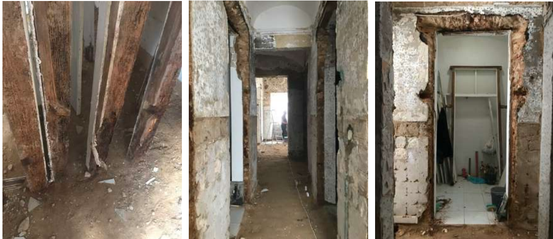
Figura 146 – Deterioração das madeiras dos aros das portas, consequência da humidade. Figura 147– Corredor central decapado. Figura 148 – Estado dos vãos após a remoção dos aros das portas. É visível o estado de deterioração causado pela humidade.
