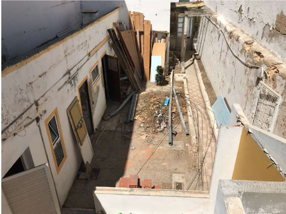
Figura 80 – Fotografia do exterior. Remoção de elementos antes do início da nivelção de pavimentos.
