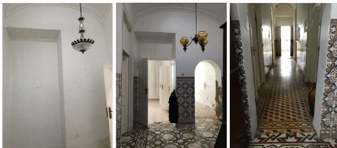
Figura 172 – Fotografia parcial do quarto um, onde é possível verificar a existência de humidades ascendentes nas paredes junto à porta. Figura 173 – Fotografia do hall principal e do corredor central.
