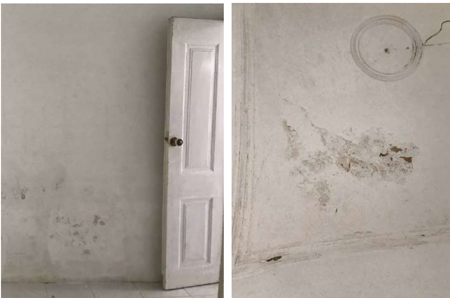
Figura 128 -Acesso ao hall de distribuição a través do corredor de entrada. É visível a quantidade de humidade presente na parede. Figura 129 – Teto abobadado do hall de distribuição. Apresenta sinais de humidade avançada, destruindo parcialmente a pintura e molduras existentes.
