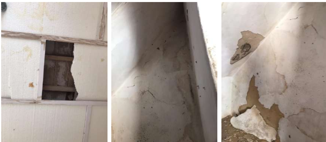
Figura 104 – Teto do anexo onde é possível observar a estrutura original. Figura 105 - Paredes danificadas sob a zona das escadas, junto à parede interior do anexo. Figura 106 – Sinais de humidade e fragilidade estrutural nas paredes que suportam as escadas
