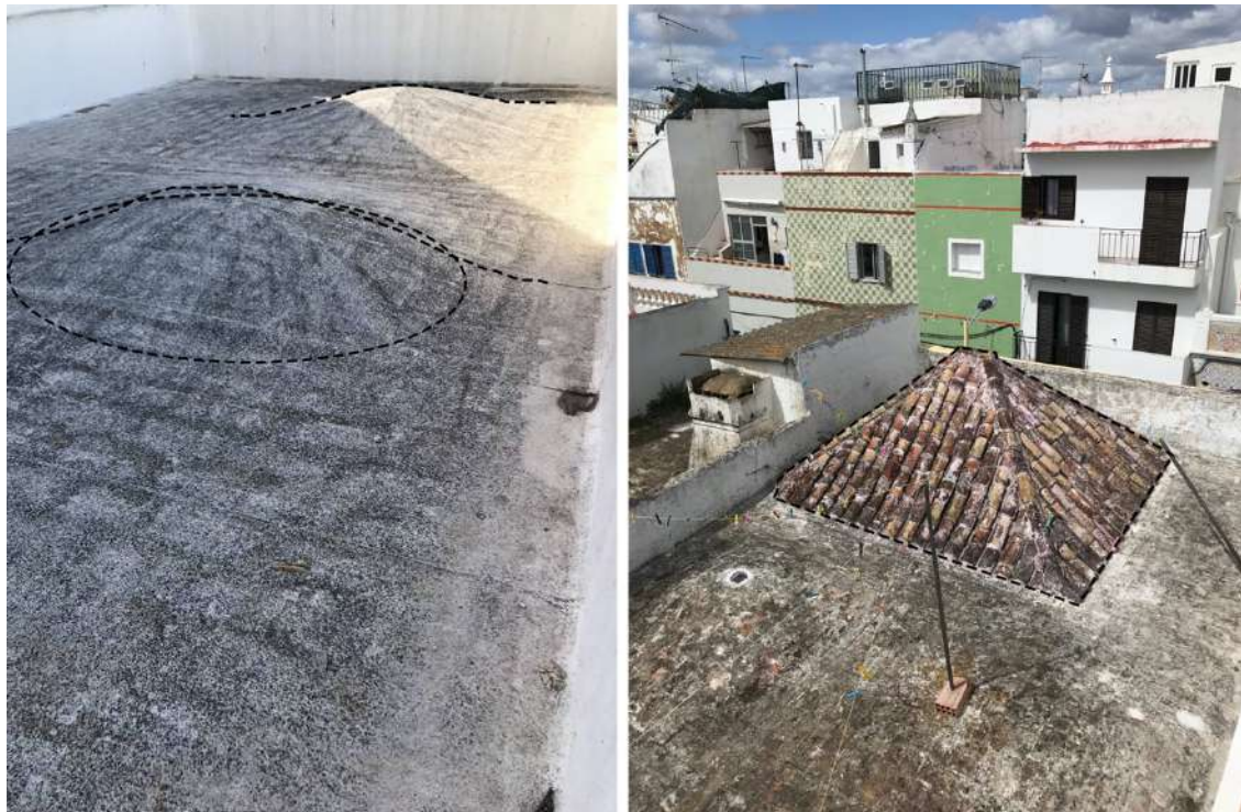
Figura 27 - Telhado abobadado na rua Manuel de Oliveira Nobre. Figura 28 - Telhado de Tesouro na rua do Sol Posto.
