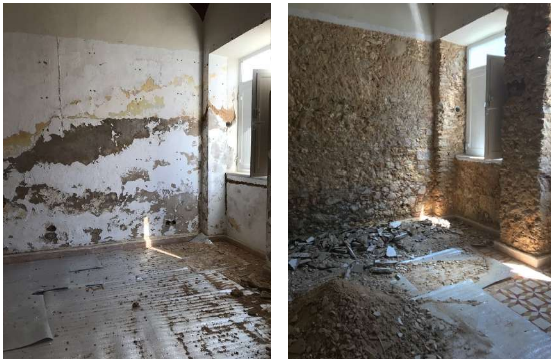
Figura 74 – Fotografia da “casa de fora”, após a remoção do gesso cartonado. Figura 75 – Fotografia da “casa de fora” após a remoção dos revestimentos e a picagem das paredes até à alvenaria.
