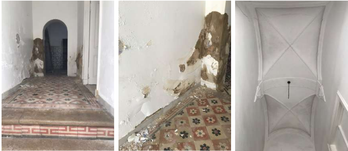
Figura 170 – Estado do corredor de acesso à casa e imagem do teto.
