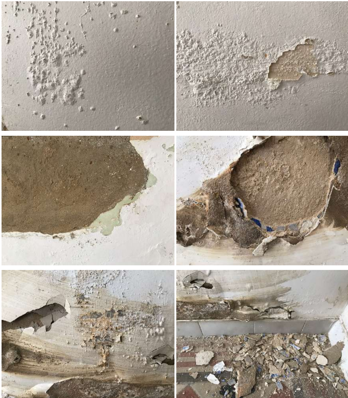
Figura 183 – Estado das paredes do corredor.
