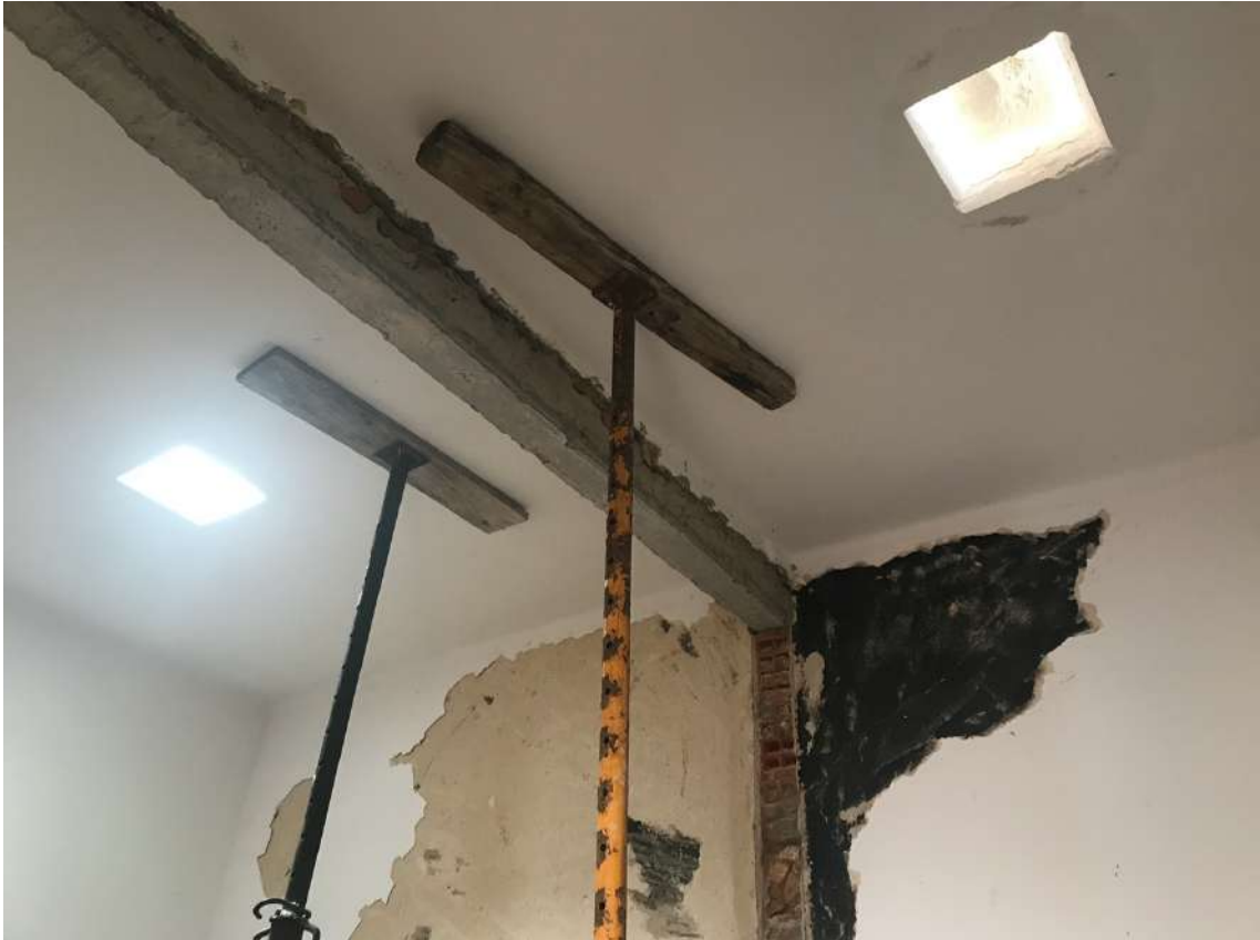
Figura 111 – Fotografia do reforço estrutural necessário ao demolir a parede que divide os dois quartos. Este passa a ter duas entradas de luz, aumentando o conforto dentro da nova divisão.
