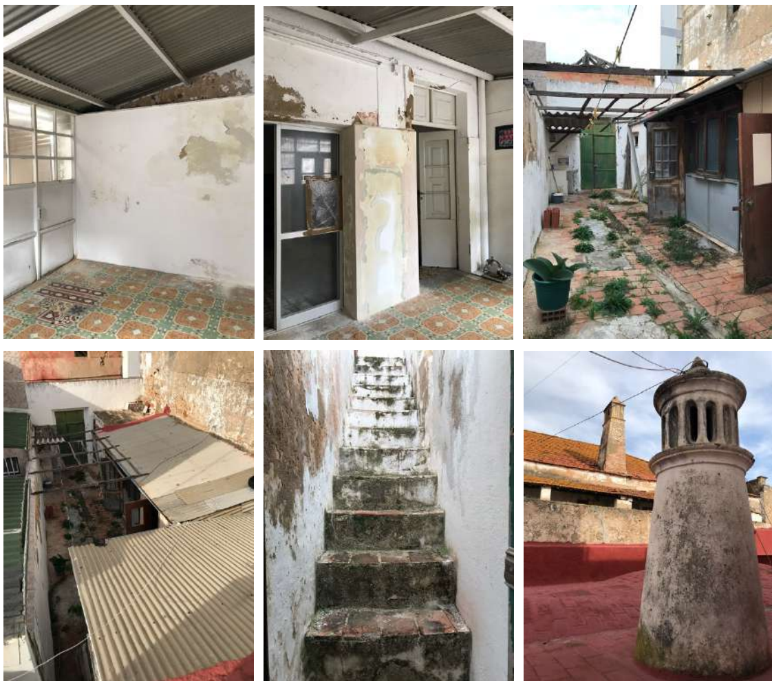
Figura 179 – Fotografias interiores de parte do anexo exterior. Figura 180 – Fotografia exterior do acrescento. É possível observar que foi construída mais do que uma divisão. Figura 181 – Fotografia da escada e a chaminé existente na açoteia. Apresentam sinais de desgaste e musgo criado pelas chuvas sazonais.
