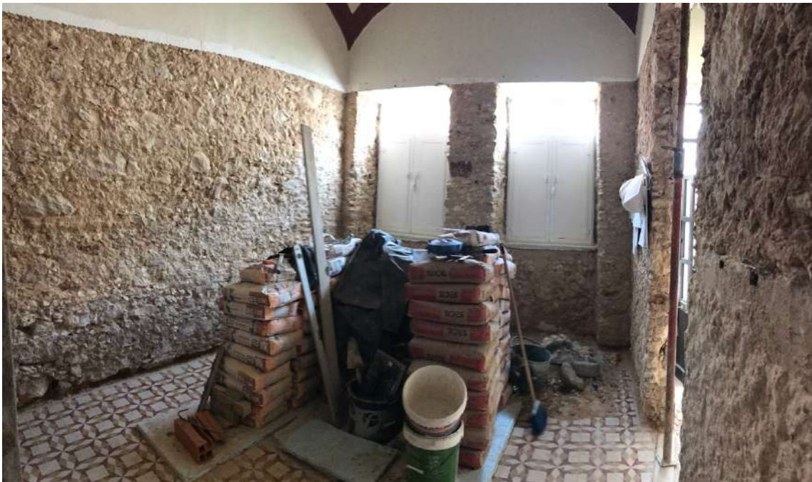
Figura 81 – Fotografia da “casa de fora”. Elementos a serem aplicados para salubrificação das paredes e compartimentos da casa.
