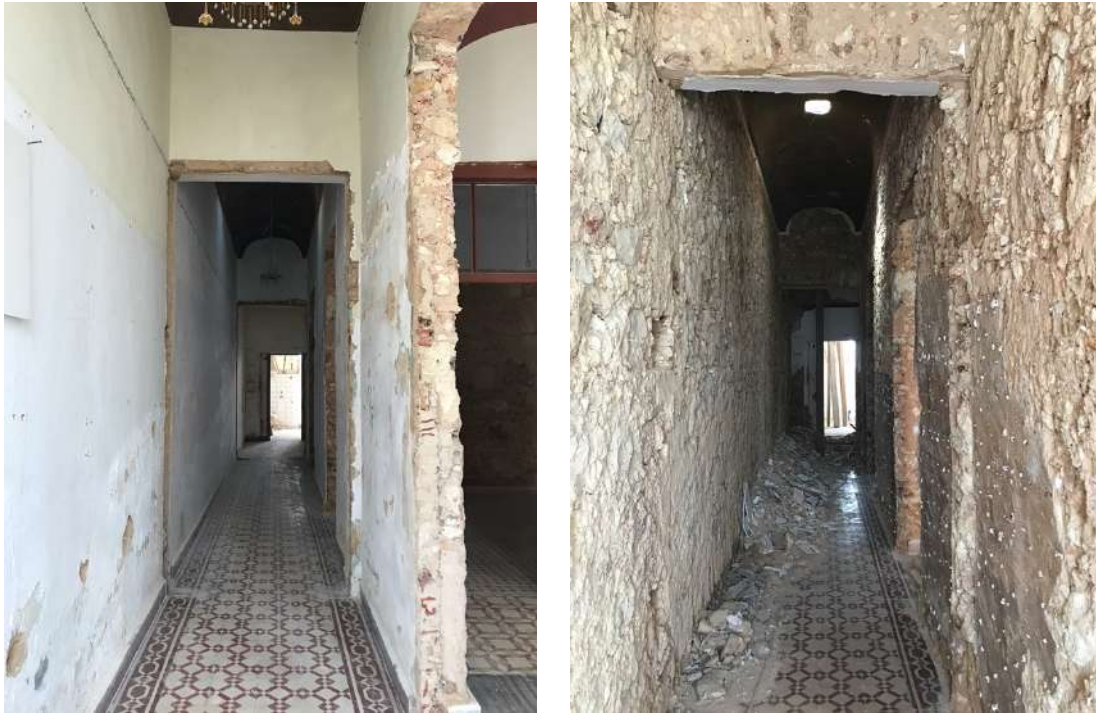
Figura 72 – Fotografias do corredor de acesso, vista frontal. Durante a remoção das placas de gesso cartonado e após a picagem das paredes. Figura 73 – Fotografia do corredor de acesso, visto desde o espaço da sala.
