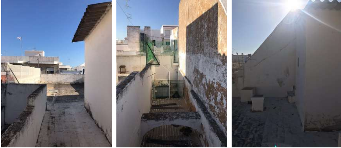
Figura 101 – Corredor de acesso à açoteia. Figura 102 - Arcos tradicionais existentes sobre a cobertura de zinco. Figura 103 – Lateral do anexo com escada de acesso ao mirante.
