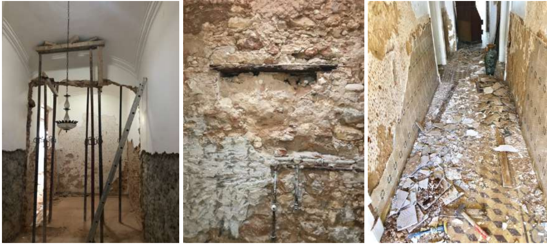
Figura 185 – Estado das paredes do corredor. Figura 186 – Fotografia do antigo vão existente na instalação sanitária central. Fotografia 187 – Corredor central durante a primeira fase de remoção de revestimentos.
