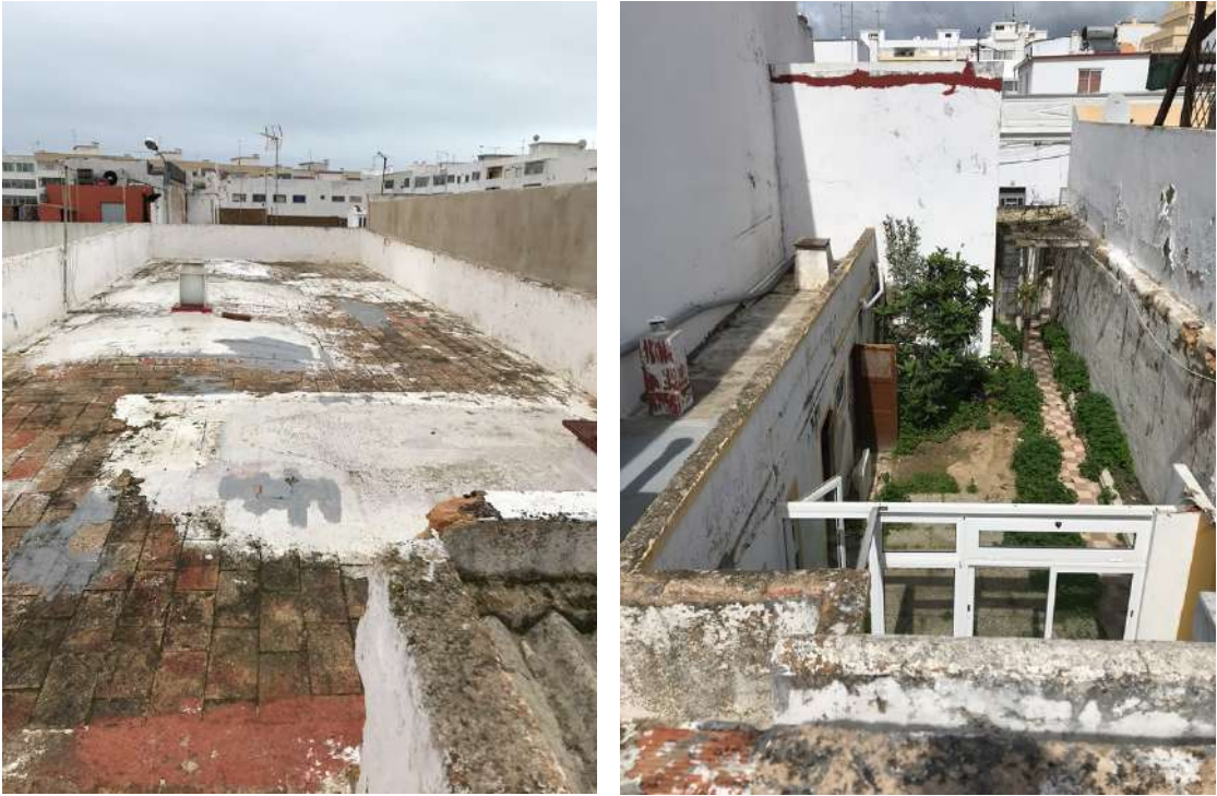
Figura 70 – Fotografia da cobertura da casa. Apresenta vários sinais de deterioração e problemas estruturais. Figura 71 – Fotografia superior do pátio. É possível identificar o acesso tardoz e o espaço ocupado pelos anexos. A cobertura destes encontra-se frágil e danificada pelo tempo.
