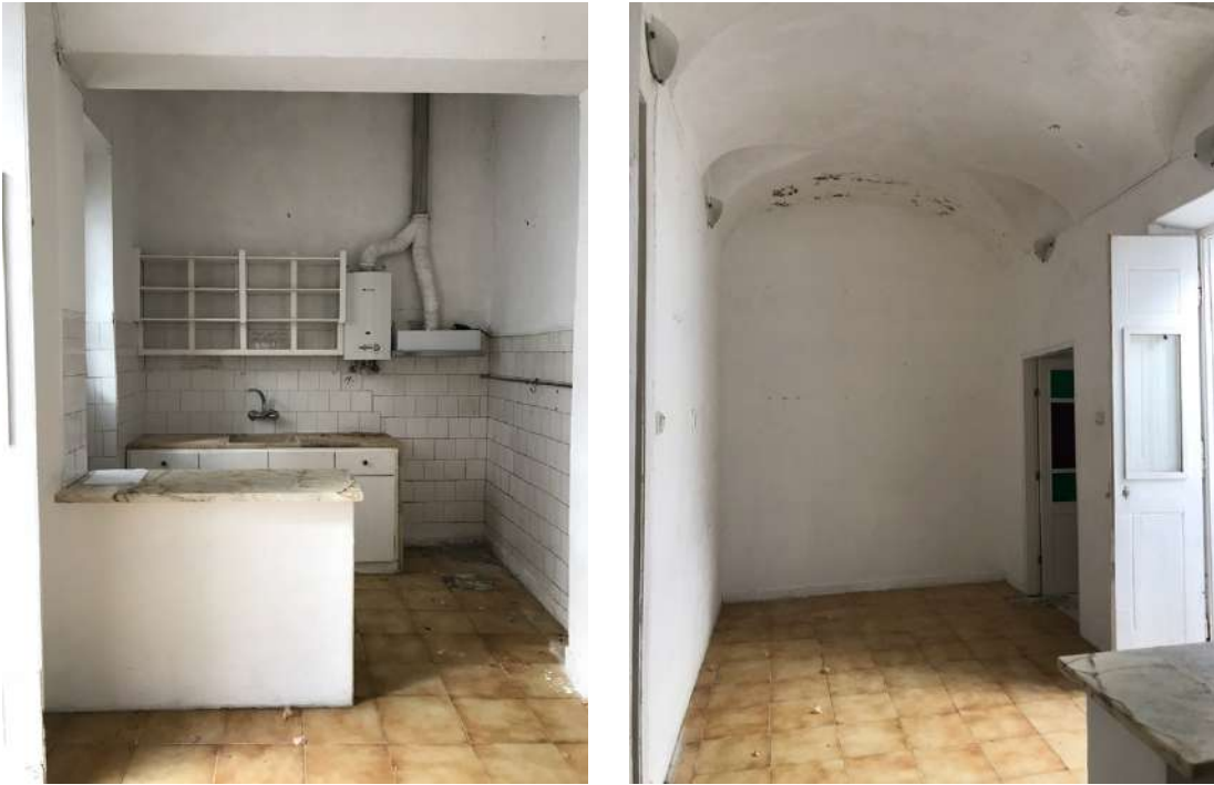
Figura 134 - Fotografia da cozinha. É possível ver os diferentes tipos de revestimentos existentes. Figura 135 – Fotografia da sala, com humidades presentes na abóbada.
