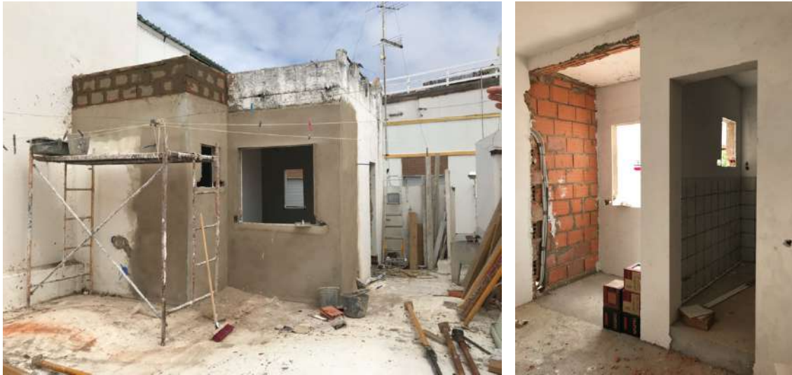
Figura 155 – Açoteia, fotografia na fase de ampliação do anexo. Figura 156 – Fotografia durante a aplicação de revestimentos interiores.
