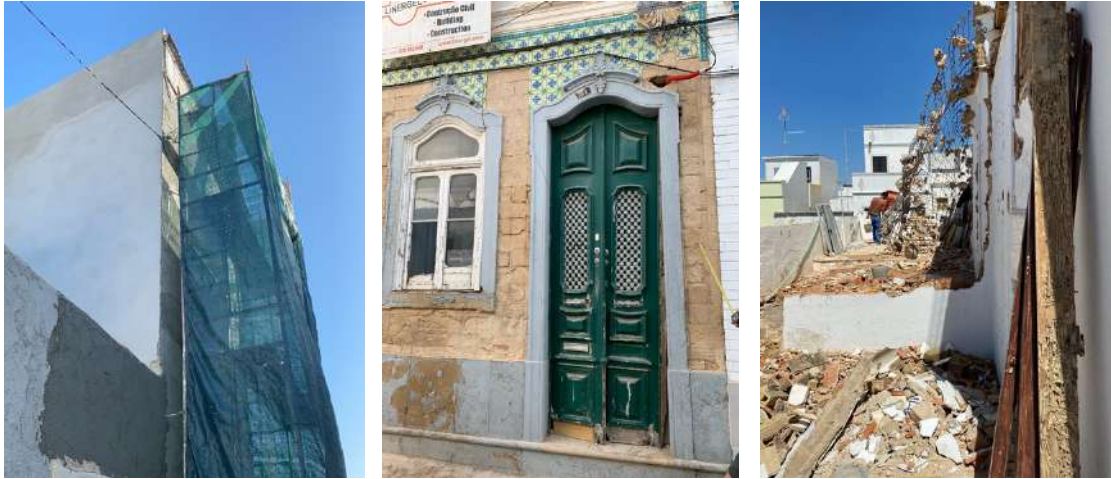
Figura 39 - Fachada com trabalhos a decorrer na rua da Cerca do Filipe. Figura 40 - Fachada com trabalhos de restauro nos azulejos na rua Gonçalo Velho. Figura 41 - Interior de habitação parcialmente demolida na rua da Cerca.
