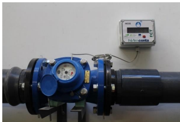
Figura 3.7: Caudalímetro eletromagnético instalado na tubagem do circuito de alimentação
