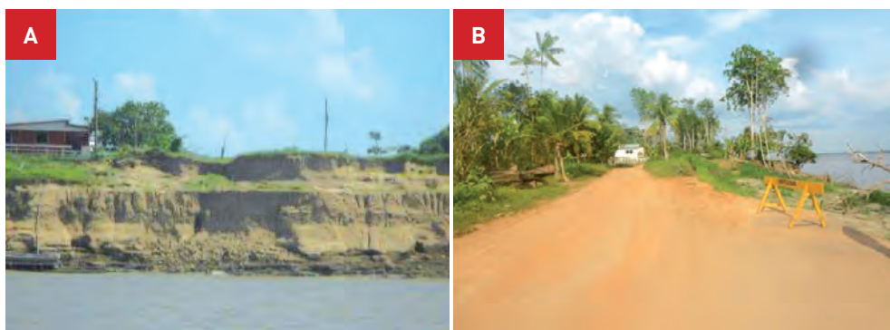
Figura 09 - Cicatrizes de erosão de margem na área rural de Careiro da Várzea (A) e aspecto da paisagem na Costa do Arapapá em Manacapuru onde a comunidade é afetada pelo processo de erosão fluvial com comprometimento da estrada parcialmente interditada (B) Foto: Tiago F. Rodrigues, 2014.
