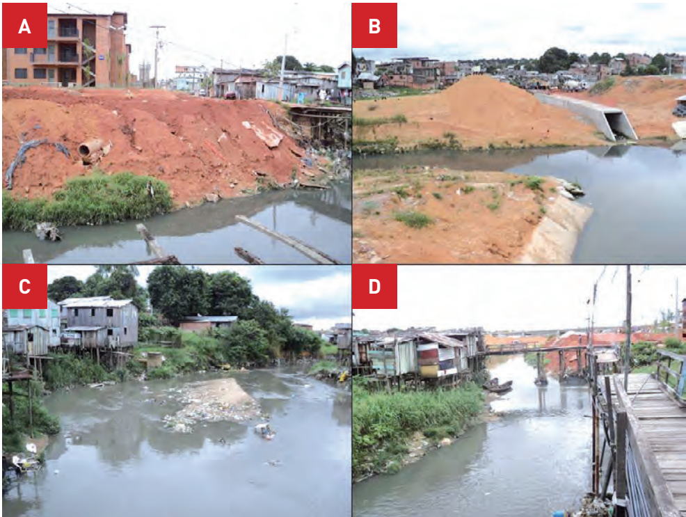
Figura 12 - Visualização das proximidades com a foz da Bacia Hidrográfica do Educandos (BHE). A e B – Área de intervenção do programa social, com obras em andamento, e a visualização das saídas de emissários, que sem tratamento de esgoto despeja as águas servidas no leito fluvial; C e D – Paisagem da área próxima à BHE, presença de assoreamento, e situação das casas com estruturas palafíticas, e cotadas para serem retiradas, devido à realização de obras do programa social.
