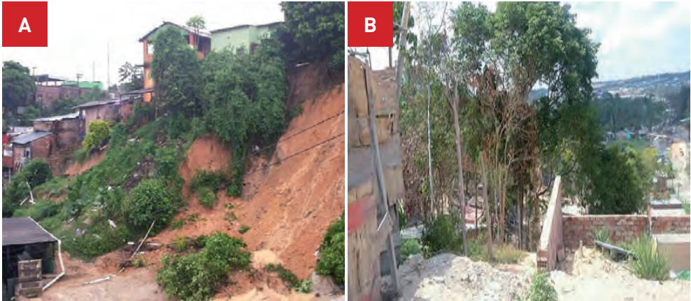
Figura 04 - (a) Terreno localizado no Conjunto Buritis localizado no bairro Nova Cidade, no qual uma parte de terra do terreno se movimentou com a ação da água da chuva (b) que infiltrou no solo e desprende-se carregando consigo sedimentos carregados pela água. Fonte: Dantas, 2015.
