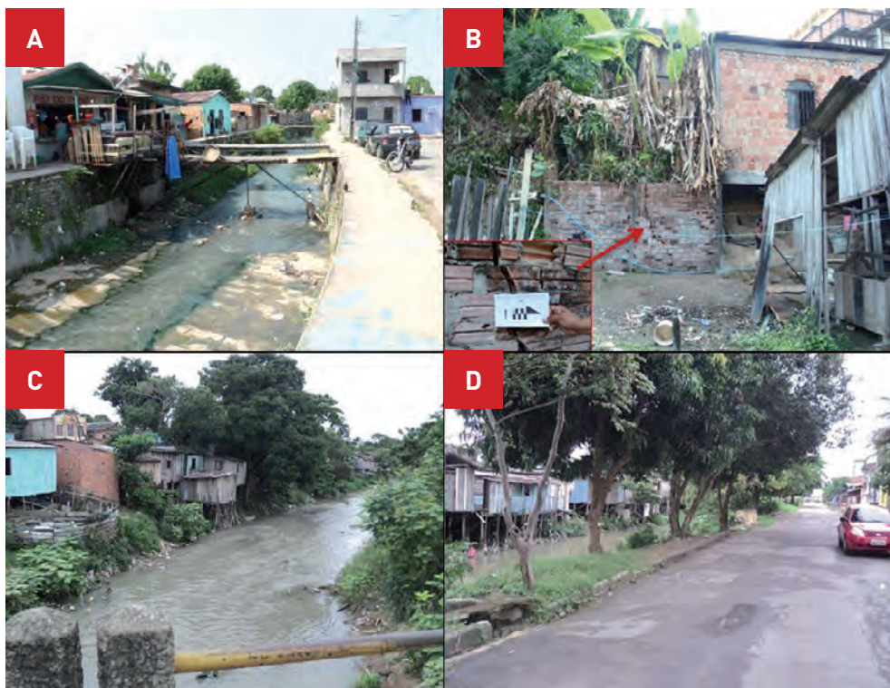
Figura 11 - Área do Médio Educandos. A - Ponte de acesso às residências, em sua maioria de alvenaria; B - Muro construído para conter a erosão da encosta, medida mitigadora do morador, muito embora esteja embarrigando e apresentando rachaduras (ver detalhe), ademais, há vegetação de bananeiras detrás do muro, que potencializa deslizamentos devido as suas propriedades de armazenamento hídrico; C - Presença parcial de vegetação, mesmo em alguns trechos inadequadas ao longo da BHE. Fonte: Acervo LAES (2011), org. MACENA, L.S.L.
