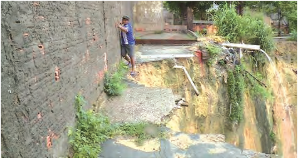
Figura 28 - Desabamento da Rua Seringal na BHM em 1 de março de 2016. O problema é recorrente, onde, nesse caso somente medidas paliativas foram tomadas. A voçoroca continua em desenvolvimento. Ver canalização de água servida que termina na voçoroca. Fonte: A crítica.com (2016) 24
