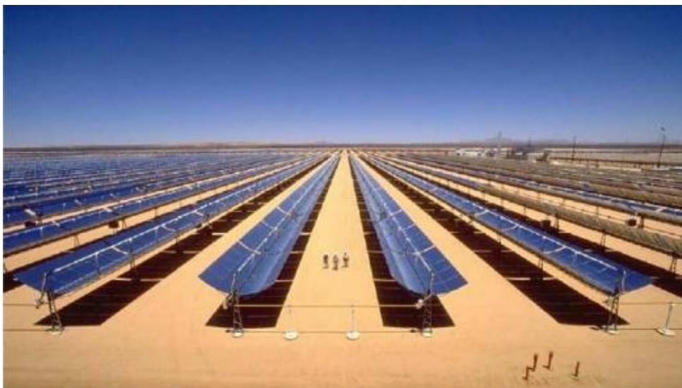
Σχήμα 1.10: Ηλιακό πεδίο παραβολικών ηλιακών συλλεκτών τύπου PTC 30 MW στο Kramer Junction της Καλιφόρνια [28]
