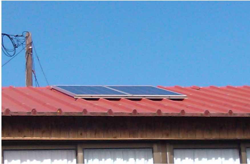
Εικόνα 2.35 Φωτοβολταϊκά πλαίσια στο αυτόνομο σύστημα
