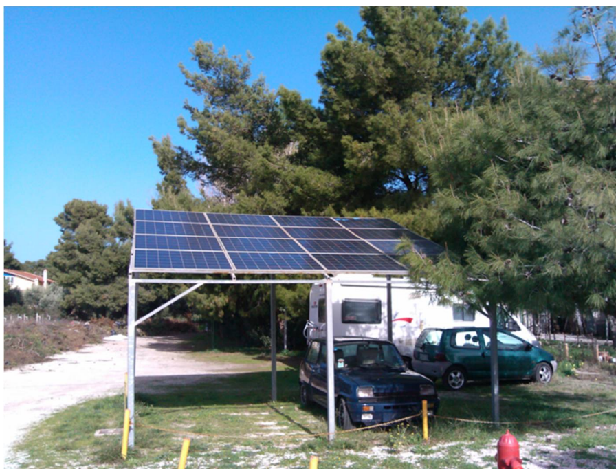
Εικόνα 2.16 Φωτοβολταϊκά πλαίσια στην είσοδο στην της κατασκήνωσης
