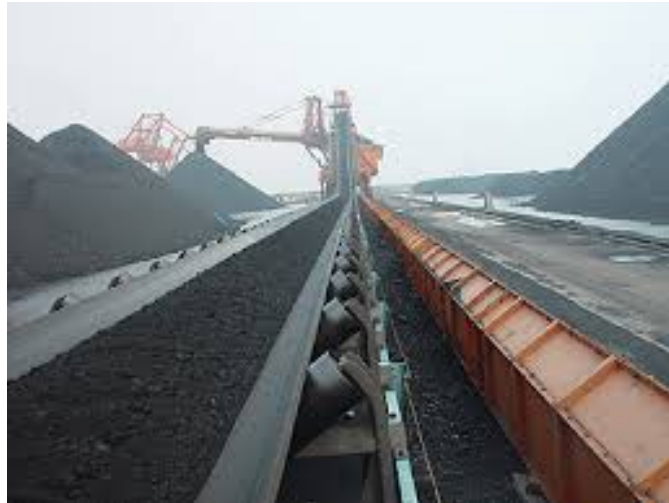
Εικόνα 2.5: Τμήμα δικτύου ταινιοδρόμων
