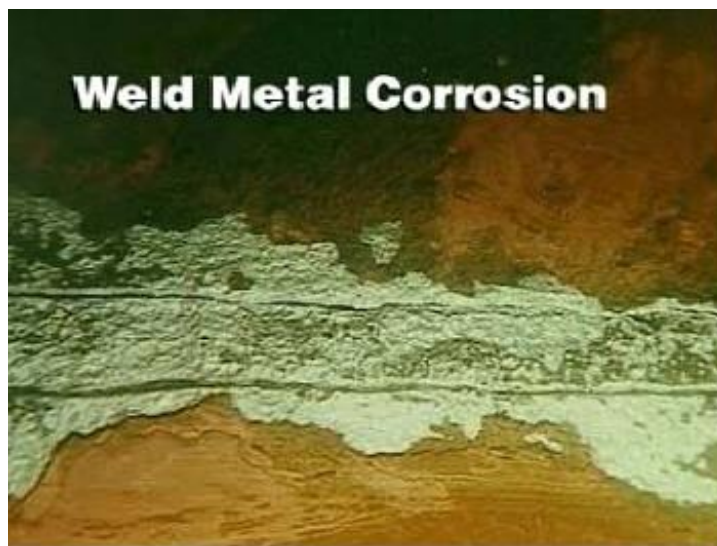
Εικόνα 3.2 : Διάβρωση στην περιοχή τη συγκόλλησης.
