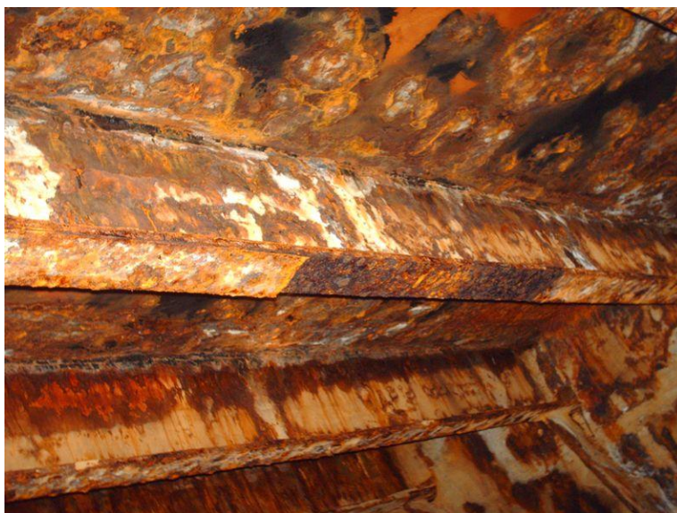
Εικόνα 3.3 : Διάβρωση ελασμάτων και ενισχυτικών άνω πλευρικής δεξαμενής έρματος.[48]
