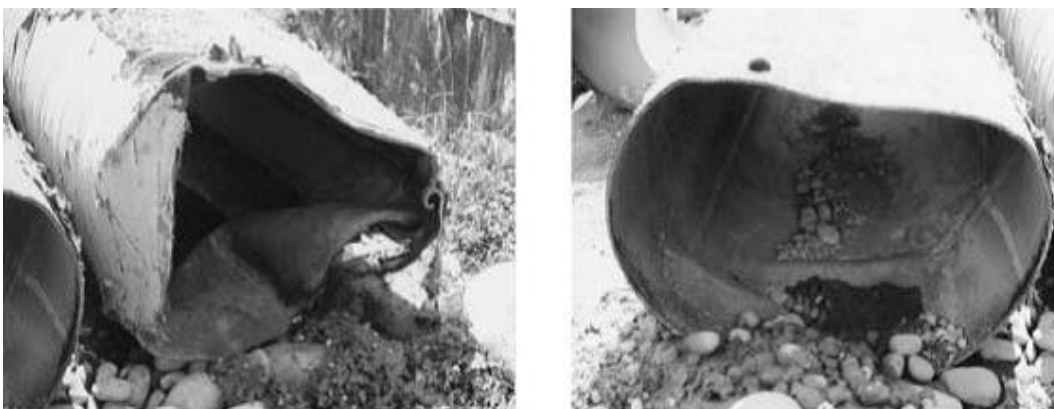
Σχήμα 1-2. Τοπικός λυγισμός μεταλλικού αγωγού [Takada et al. 2001]
