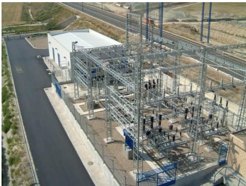
Εικόνα 4.6: Αποψη Υποσταθμού έλξης
