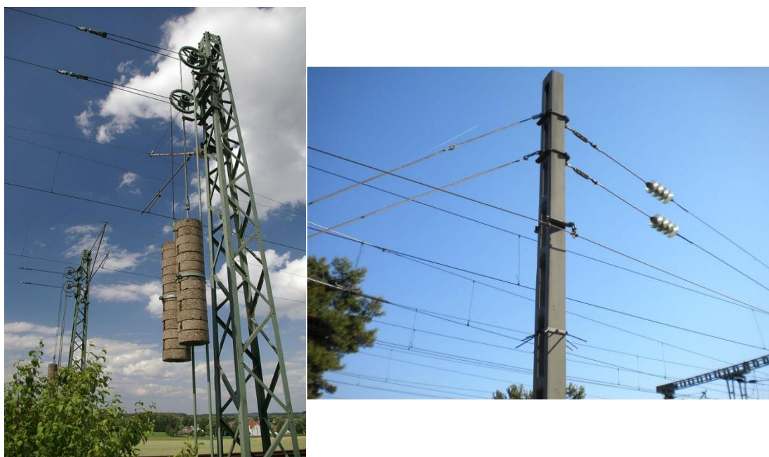
Εικόνα 4.8: Άποψη συστήματος τάνυσης (αριστερά) και στύλου αγκύρωσης (δεξιά) ( en.wikipedia.org )
