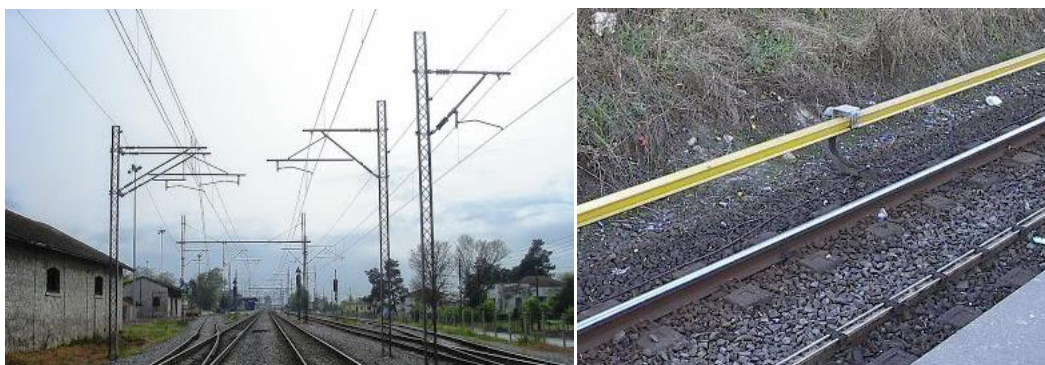
Εικόνα 4.5: Σύστημα εναέριας τροφοδοσίας (αριστερά) και τρίτης σιδηροτροχιάς (δεξιά)
