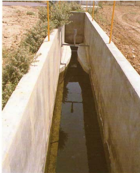
Σχήμα 2.1 : Διώρυγα Parshall με αισθητήριο στάθμης για μέτρηση παροχής
