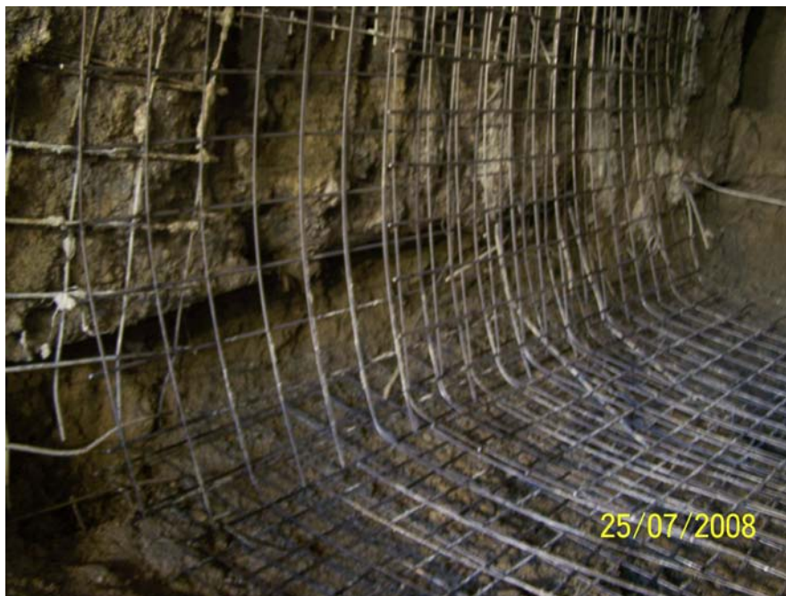
Εικόνα 11.6: Διάταξη δομικού πλέγματος πριν την εφαρμογή εκτοξευόμενου σκυροδέματος. (Φωτογραφικό Αρχείο Αττικό Μετρό)
