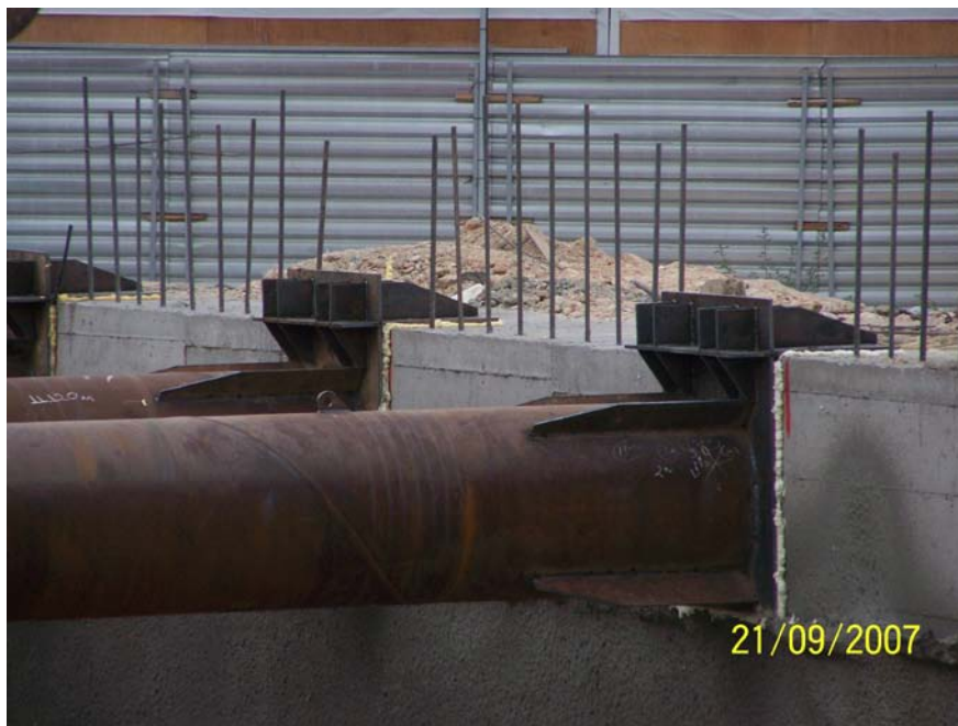
Εικόνα 9.1: Αντηρίδα εδραζόμενη επί του έγχυτου κεφαλοδέσμου. Τα κενά πληρώνονται με πολυουραιθάνη (Φωτογραφικό Αρχείο Αττικό Μετρό)
