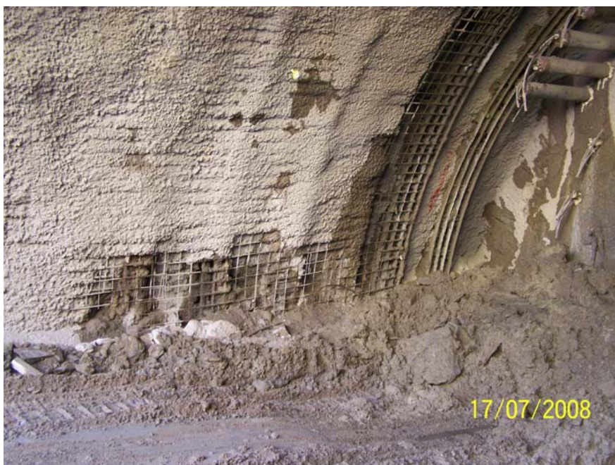
Εικόνα 11.4: Σύστημα προσωρινής αντιστήριξης (δομικό πλέγμα και εκτοξευόμενο σκυρόδεμα). (Φωτογραφικό Αρχείο Αττικό Μετρό)
