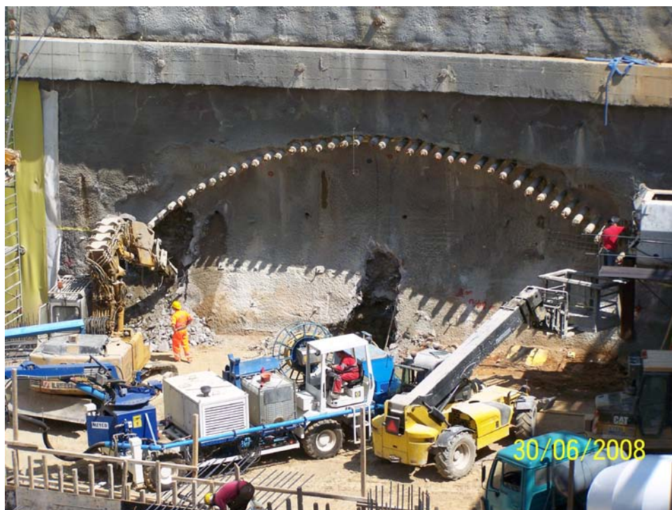
Εικόνα 10.2: Τοποθετημένοι δοκοί προπορείας (forepoling) πριν την εκσκαφή του θόλου της σήραγγας υπογείου τμήματος του Σταθμού. (Φωτογραφικό Αρχείο Αττικό Μετρό)
