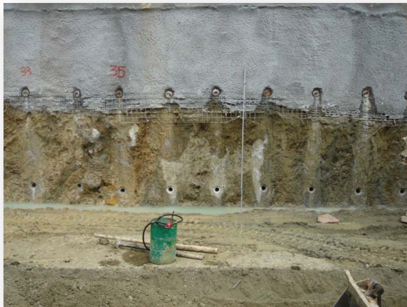
Εικόνα 2: Σειρά αγκυρίων για ενίσχυση της αντιστήριξης στους κάθετους τοίχους του σταθμού (ΑΤΤΙΚΟ ΜΕΤΡΟ Α.Ε.).
