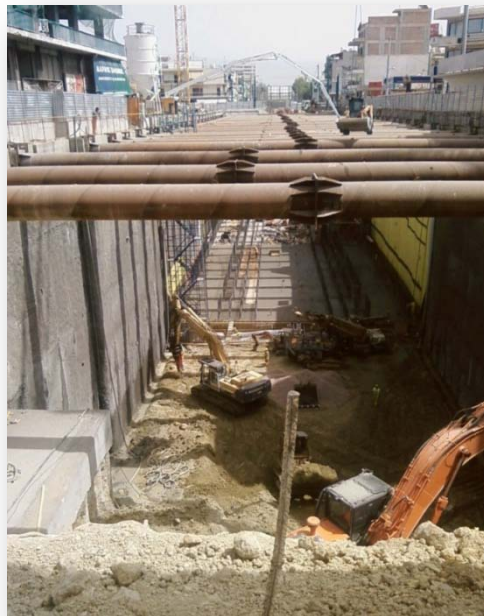
Εικόνα 10.2: Αντιρήδες στο σταθμό "Ανθούπολη" (ΑΤΤΙΚΟ ΜΕΤΡΟ Α.Ε.)
