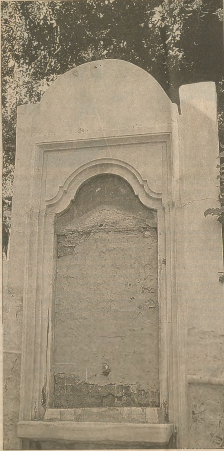
Tezkireci Camii Sokak'taki çeşme tuğla ile örülüp kapatılmış.
