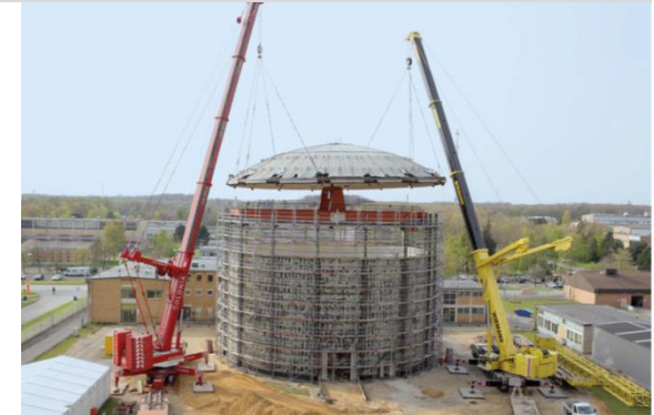
Source: Forschungszentrum Jülich GmbH
