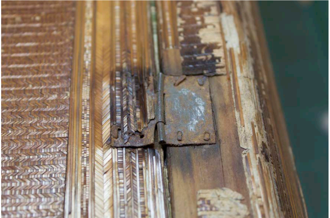
Kuva 8. Vasemman puoleinen puoliksi irtonainen sarana (omat kuvakokoelmat).
