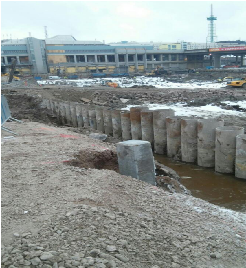
KUVA 10. Luiska sortunut paalun kohdalta. Vieressä porapaaluseinä
