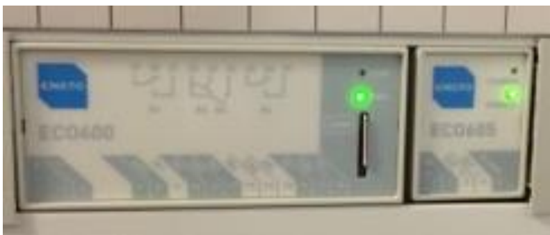
Kuva 14. Ensto ECO600 keskuksessa.
