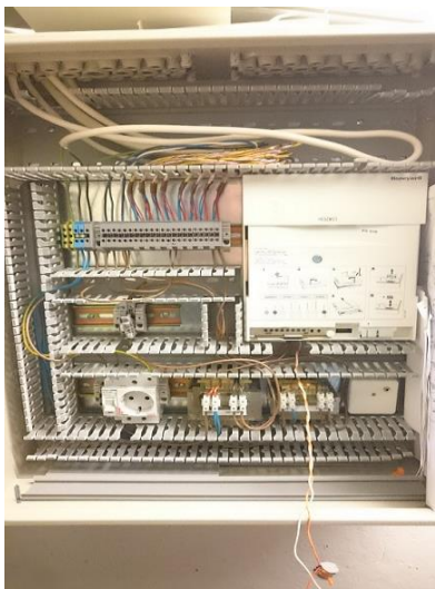
Kuva 10. Kerroksissa sijaitseva huonesäädinten ohjausyksikkö Honeywellin Zone Manager.
