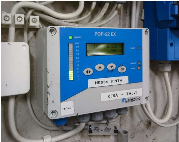
Kuva 16. Pinnankorkeuden mittaamiseen käytetty Labkotec POP-22 EX-keskusosa.
