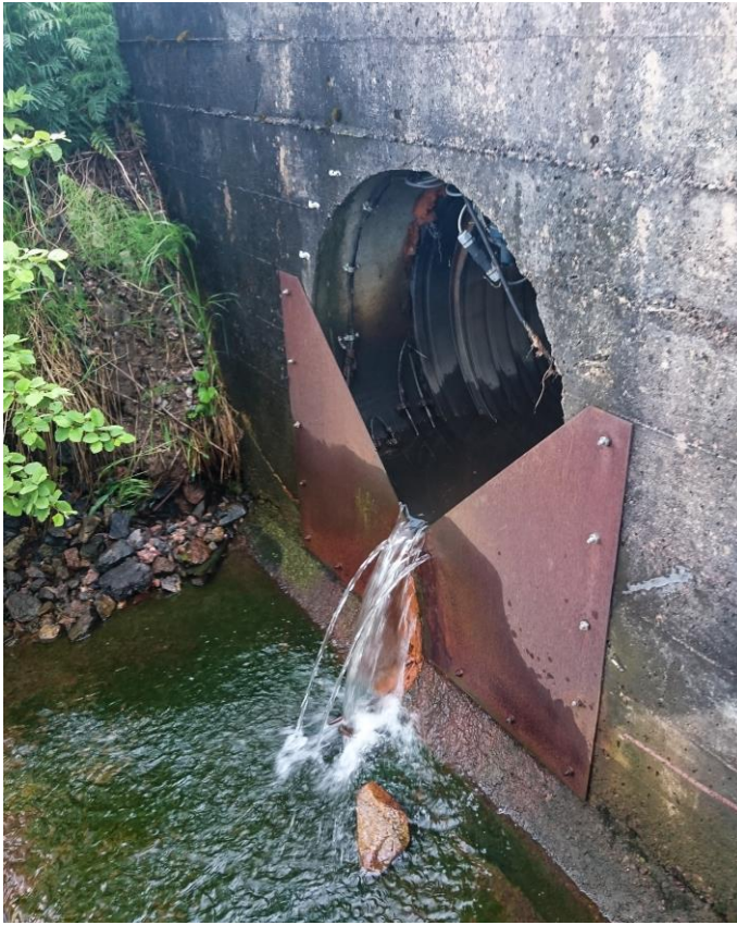
Kuva 11. Kylmäojaan johdetun puhtaan veden mittapato.
