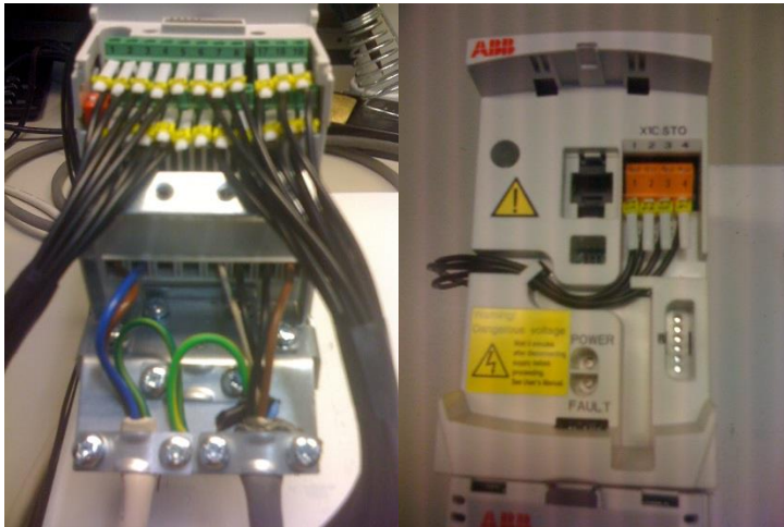
Kuva 20. Taajuusmuuttajan I/O- ja teholiitännät.
