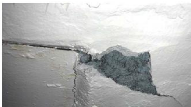
Bild 2. Ventilationskanal som är isolerad med krokidolit som sedan är besprutad med antofyllit. (RT 20-11160, 2014)
