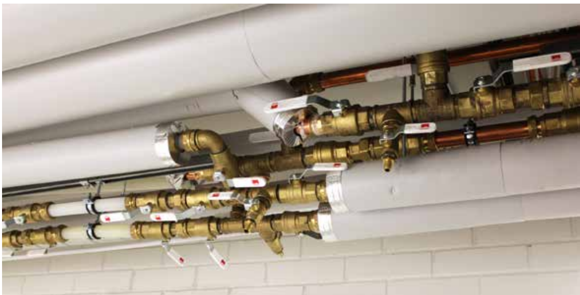
Kuva 2-2. Teknologiatalo Syyttimen käyttövesiverkosto on jaettu PEX- ja kuparilinjaan, joihin molempiin on asennettu myös putkikeräimiä (tutkimustarkoituksessa).
