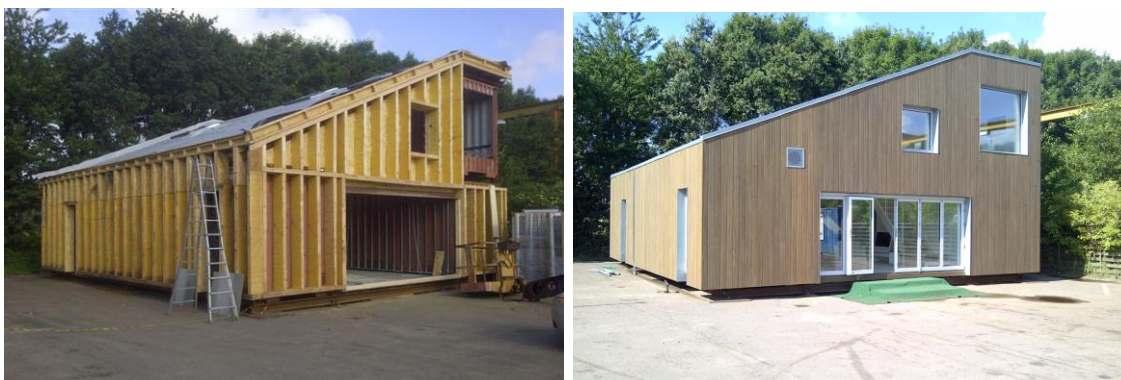
Kuva 20. Tanskalaisessa Upcycle House -rakennuksessa lämmöneristys on asennettu osittain kontin ulkopinnoille ja osittain erillisiin puurakenteisiin, joita kontit kannattelevat tukirakenteina [58, 58].
