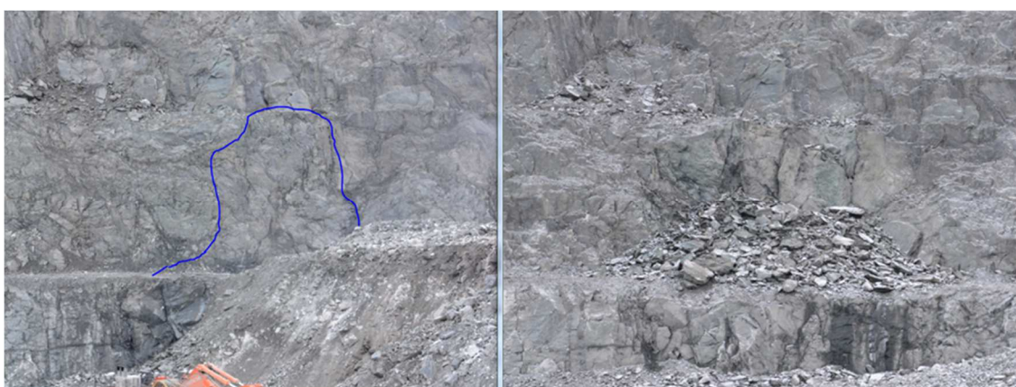
Kuvio 15. Yläpuolella Siilinjärven mobiilitutkalla havaittu sortuma, alapuolella ennen ja jälkeen kuvat samasta sortumasta (Suikkanen 2015)
